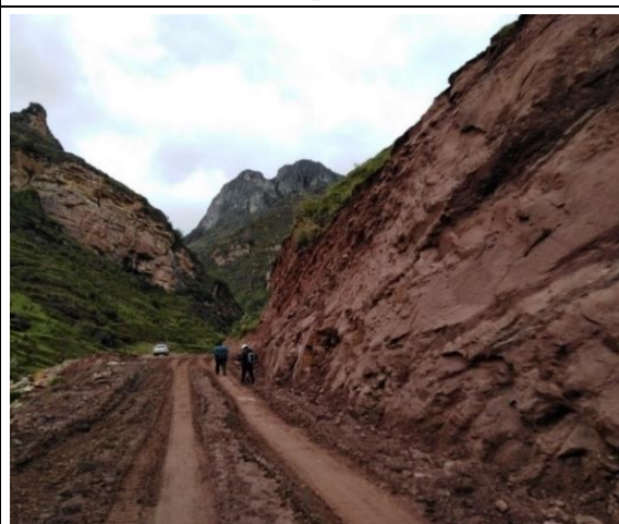
FOTO 4: Talud de corte pronunciado de tipología de suelo arcilloso. (KM 06+000)
