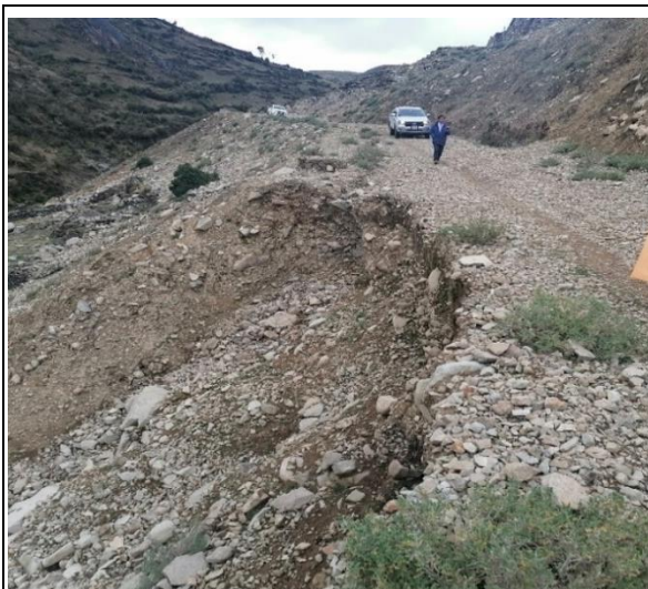
FOTO 7: Movimiento de masa del talud y desmoronamiento del extremo de la vía.
