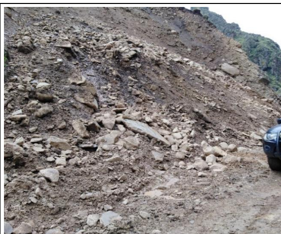
FOTO 2: Talud inestable producto de la actividad de corte y tipología del suelo.
