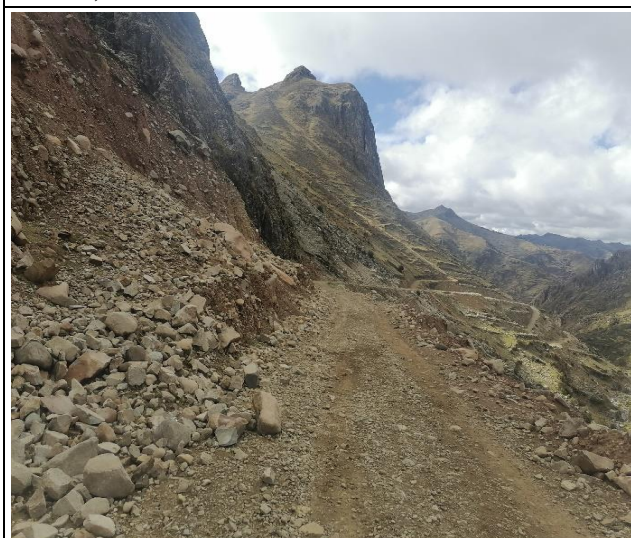
FOTO 5: Talud de corte y relleno inestable, con desprendimiento de rocas sueltas y vía en mal estado (KM 02+800).
