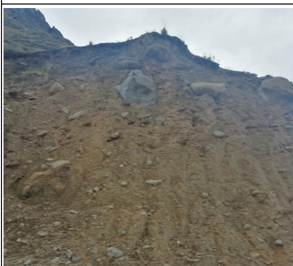
FOTO 9: Talud de corte pronunciado, que puede ocasionar peligro de desprendimiento
