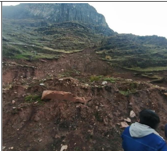
FOTO 8: Bloque de masa de suelo por inestabilidad de talud (KM 04+300).
