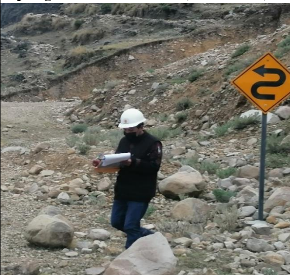
FOTO 6: Montículos de boloneras en la vía y señal vertical de tránsito (KM 03+400).
