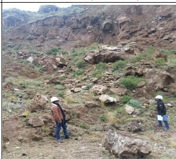
FOTO 10: Arrastre de tierras, talud de corte pronunciado e inestable, boloneras (KM 05+480).
