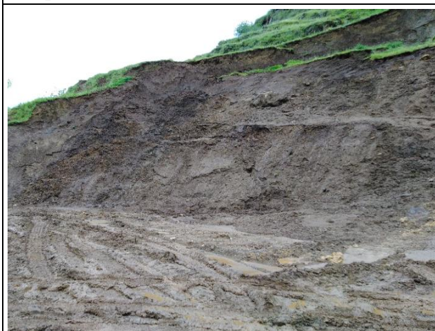
FOTO 3: Inestabilidad de taludes en el km 5+580, con movimiento de masa de suelo.
