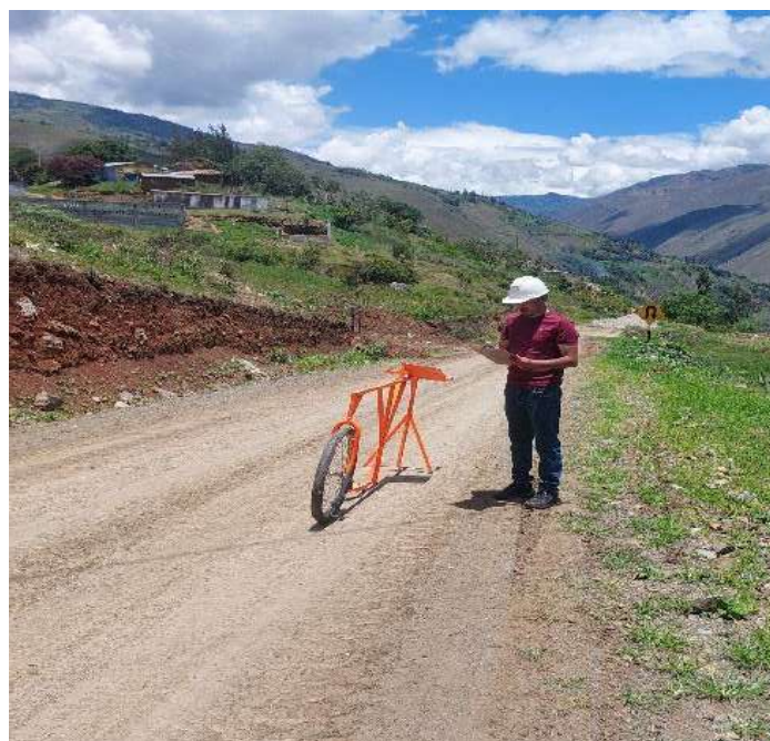
Fotografía 60: Medición de la rugosidad con el equipo merlín Prog, 0+ 060.00 – 0+071.60 (Tramo con solo afirmado)
