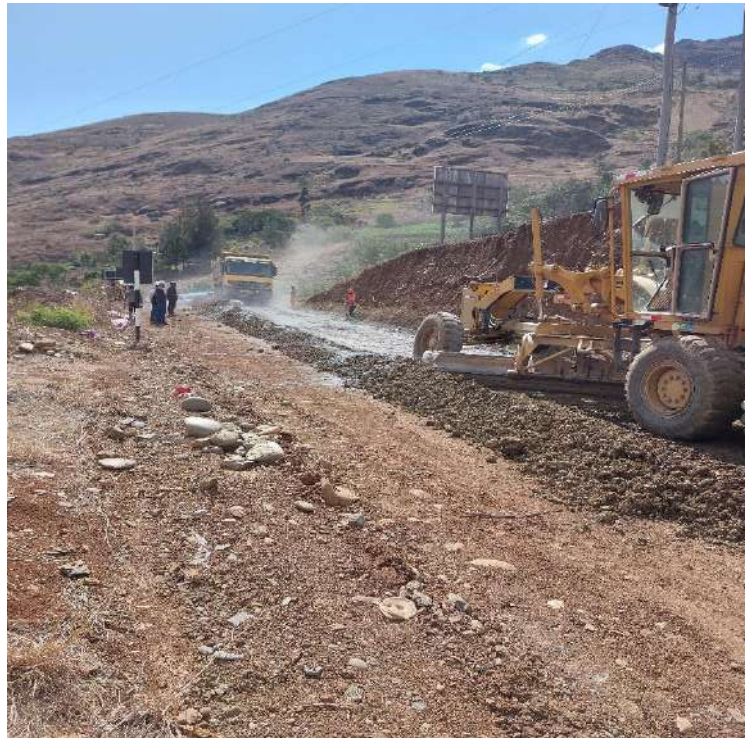
Fotografía 19: Mezclado del material de afirmado y ceniza de bagazo de caña con la motoniveladora sector ceniza. Prog. 0+015.00 - Prog. 0+030.00
