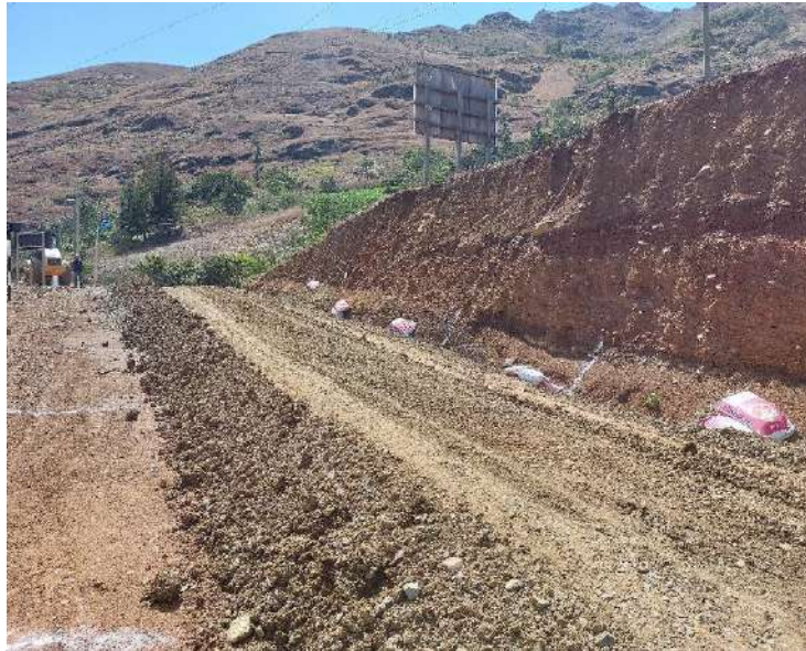
Fotografía 7: Distribución de costales de ceniza de bagazo de caña en las secciones sector ceniza Prog. 0+015.00 - Prog. 0+030.00.
