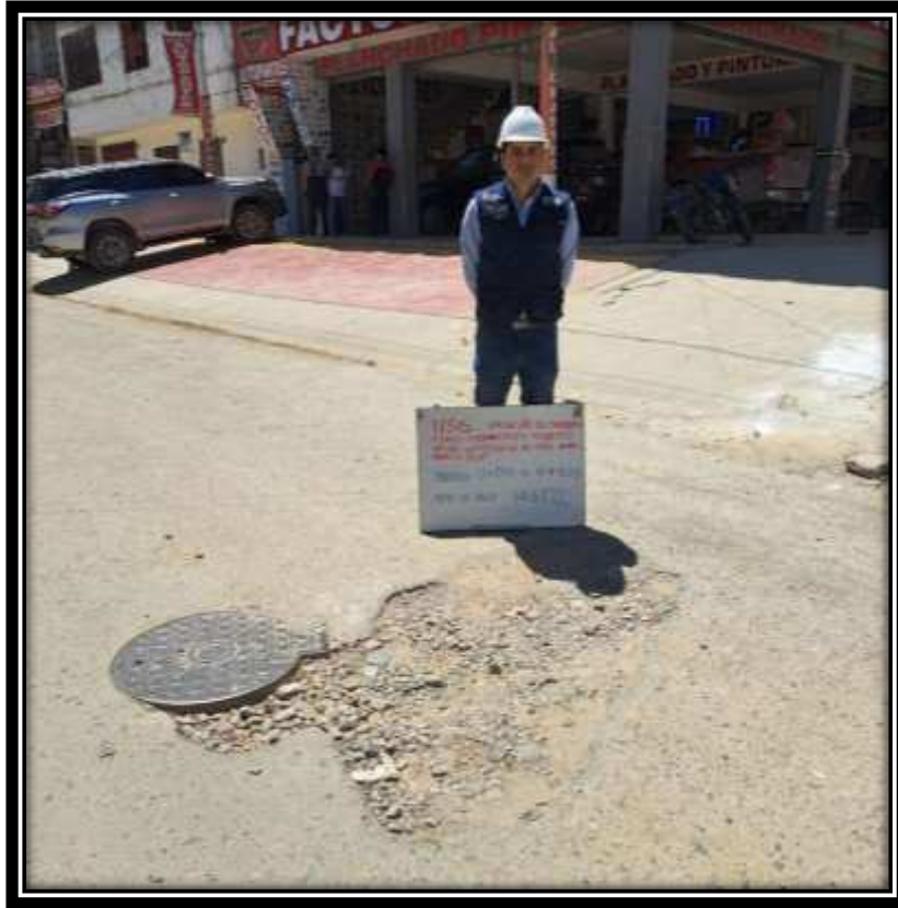
Foto N° 07: Tipo de falla: HUECO en el Km 0+250 al 0+500
