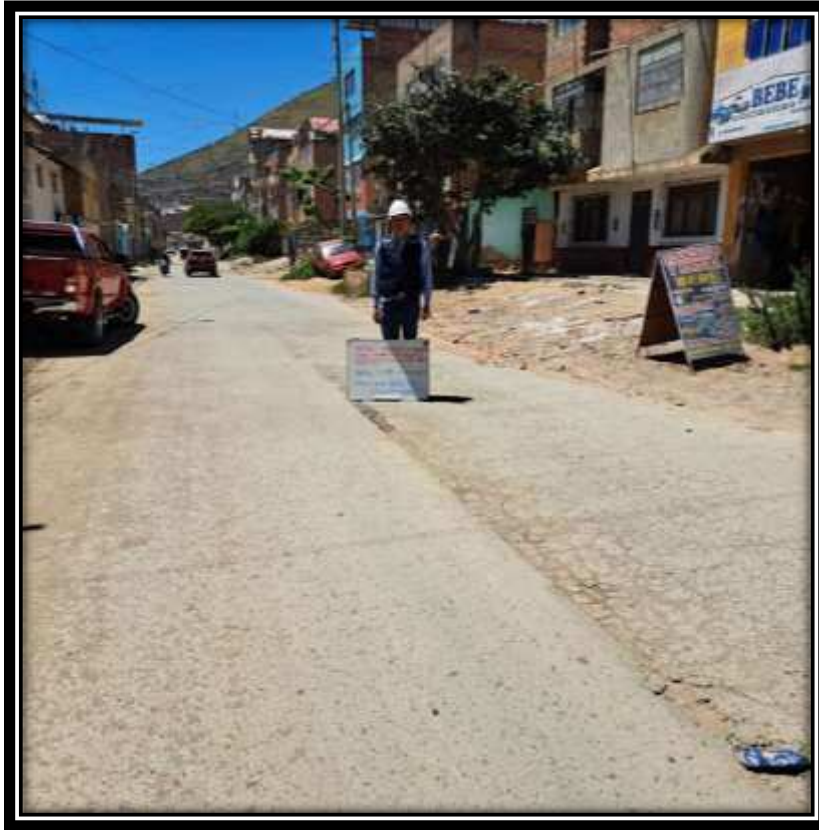
Foto N° 15: Tipo de falla: GRIETAS LONGITUDINALES en el Km 0+500 al 0+750
