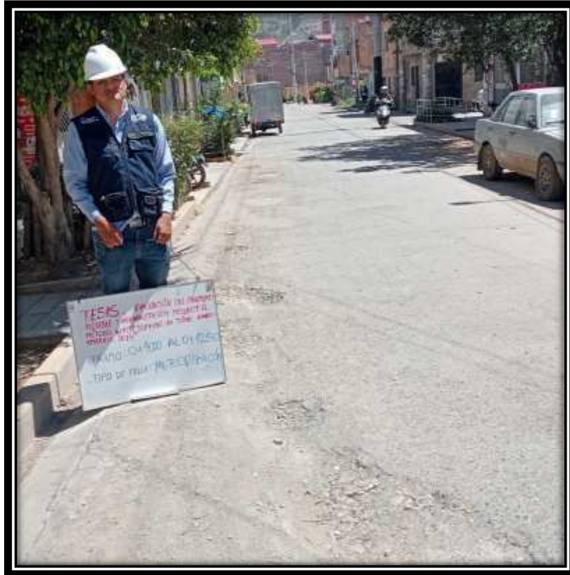
Foto N° 23: Tipo de falla: METEORIZACIÓN en el Km 0+1000 al 0+1250
