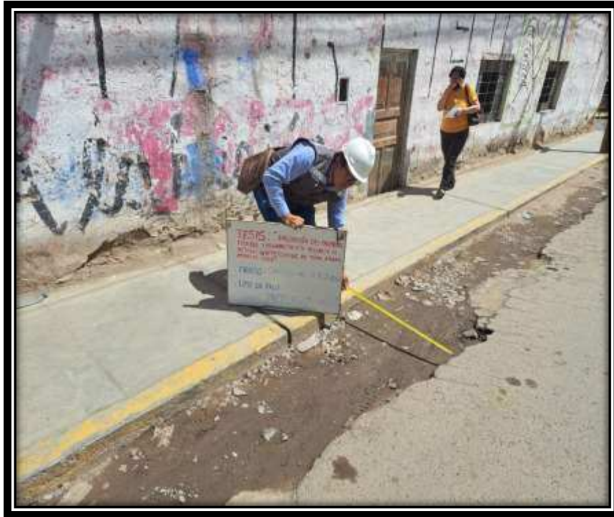
Foto N° 01: Tipo de falla: METEORIZACIÓN en el Km 0+000 al Km 0+250
