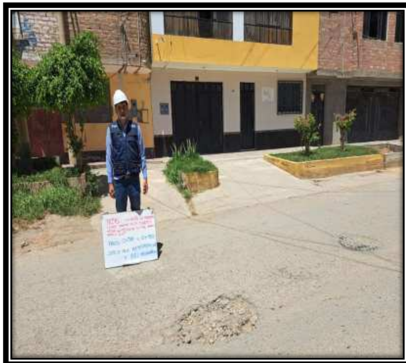
Foto N° 14: Tipo de falla: METEORIZACIÓN Y PIEL DE COCODILO en el Km 0+500 al 0+750
