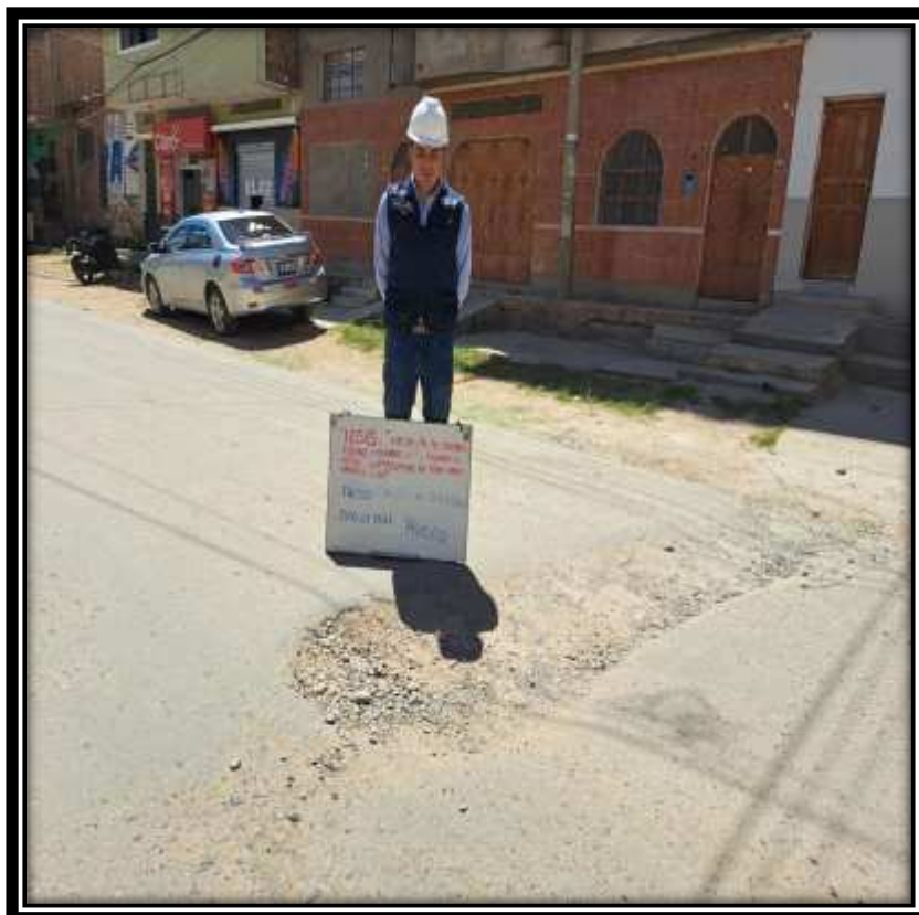
Foto N° 04: Tipo de falla: HUECO en el Km 0+000 al Km 0+250
