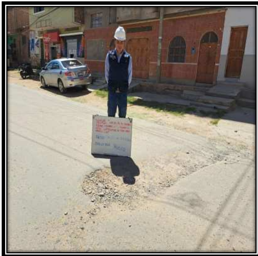
Foto N° 08: Tipo de falla: HUECO en el Km 0+250 al 0+500
