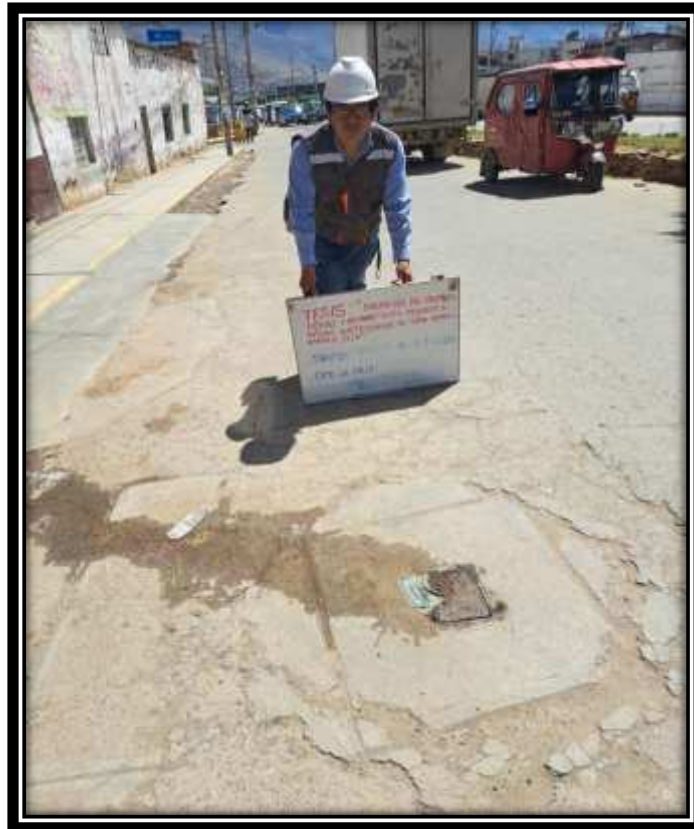
Foto N° 03: Tipo de falla: PIEL DE COCODRILO en el Km 0+000 al Km 0+250
