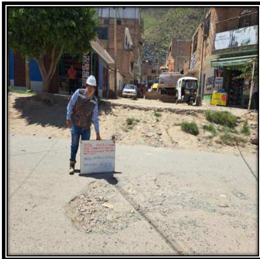
Foto N° 10: Tipo de falla: HUECO en el Km 0+250 al 0+500
