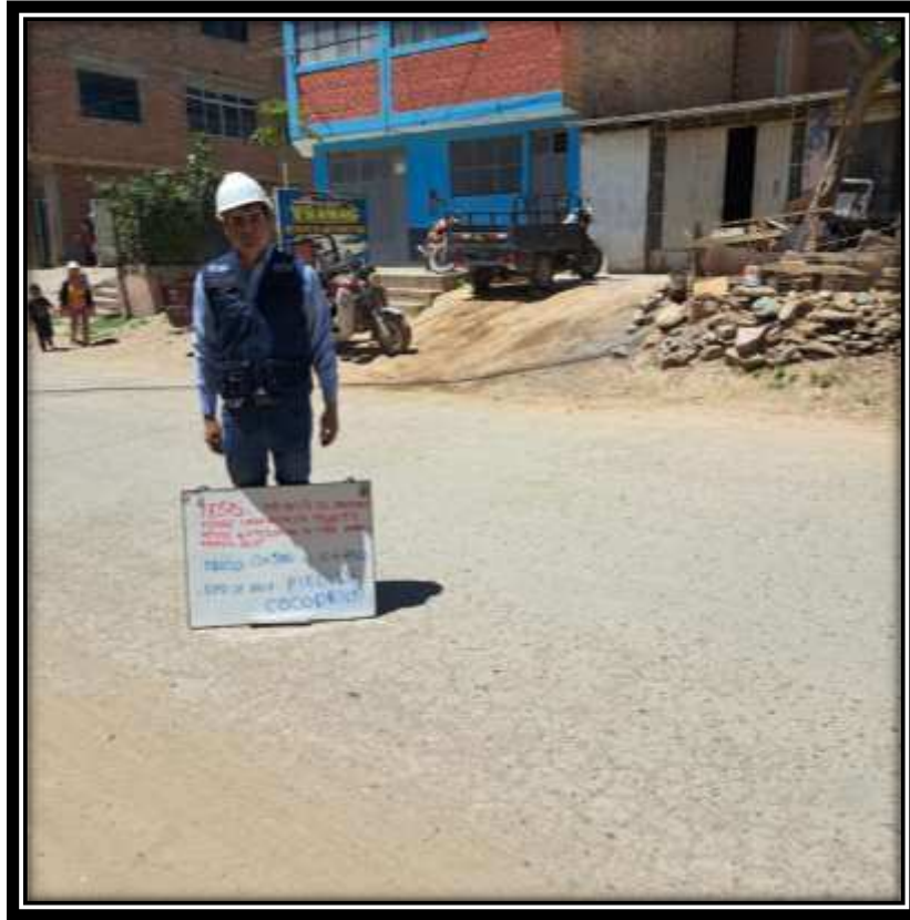
Foto N° 13: Tipo de falla: PIEL DE COCODRILO en el Km 0+500 al 0+750
