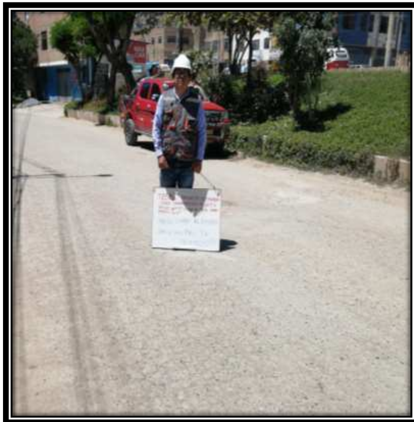
Foto N° 16: Tipo de falla: PIEL DE COCODRILO en el Km 0+750 al 0+1000
