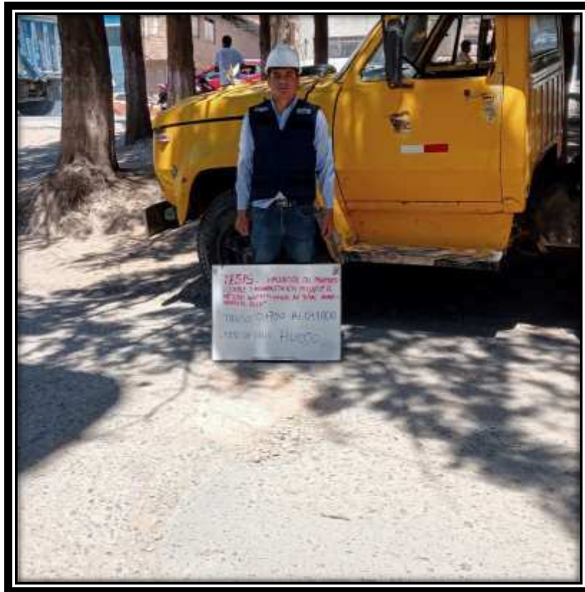
Foto N° 19: Tipo de falla: HUECO en el Km 0+750 al 0+1000
