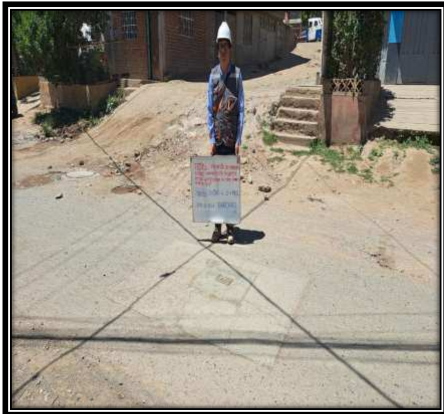
Foto N° 12: Tipo de falla: PARCHEO en el Km 0+500 al 0+750
