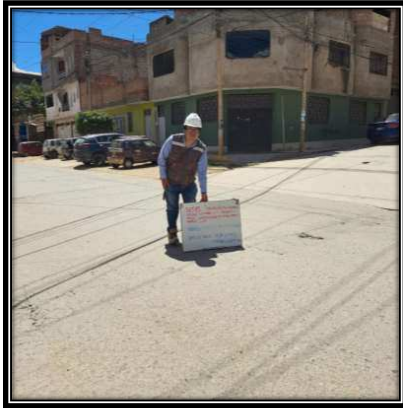
Foto N° 05: Tipo de falla: GRIETAS TRANVERSALES en el Km 0+000 al 0+250
