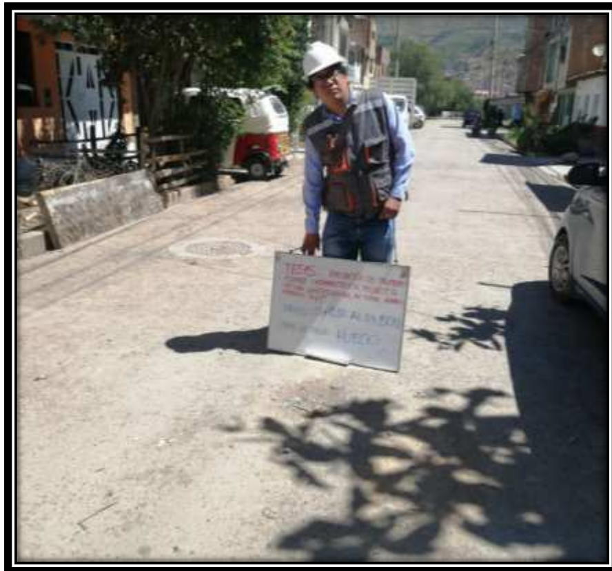
Foto N° 28: Tipo de falla: HUECO en el Km 0+1250 al 0+1500
