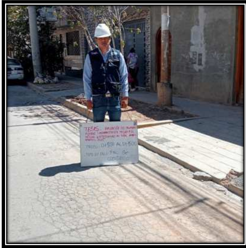
Foto N° 27: Tipo de falla: PIEL DE COCODRILO en el Km 0+1250 al 0+1500
