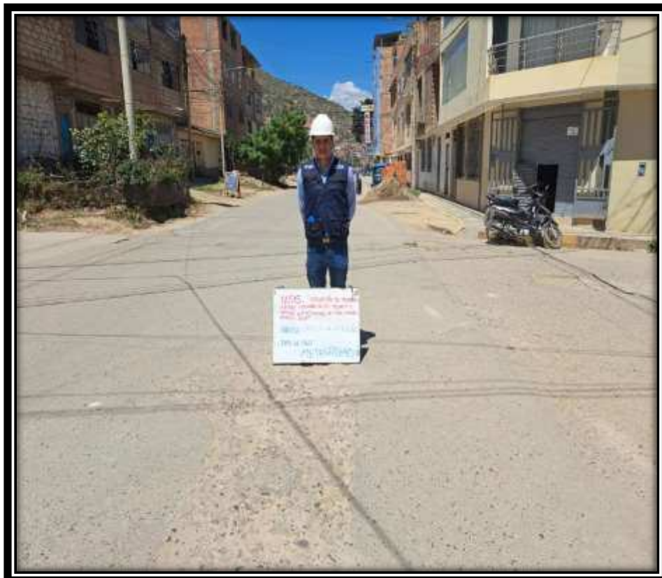
Foto N° 06: Tipo de falla: METEORIZACIÓN en el Km 0+000 al Km 0+250
