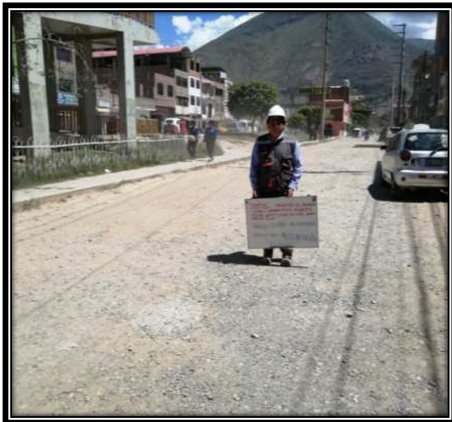
Foto N° 18: Tipo de falla: METEORIZACIÓN en el Km 0+750 al 0+1000
