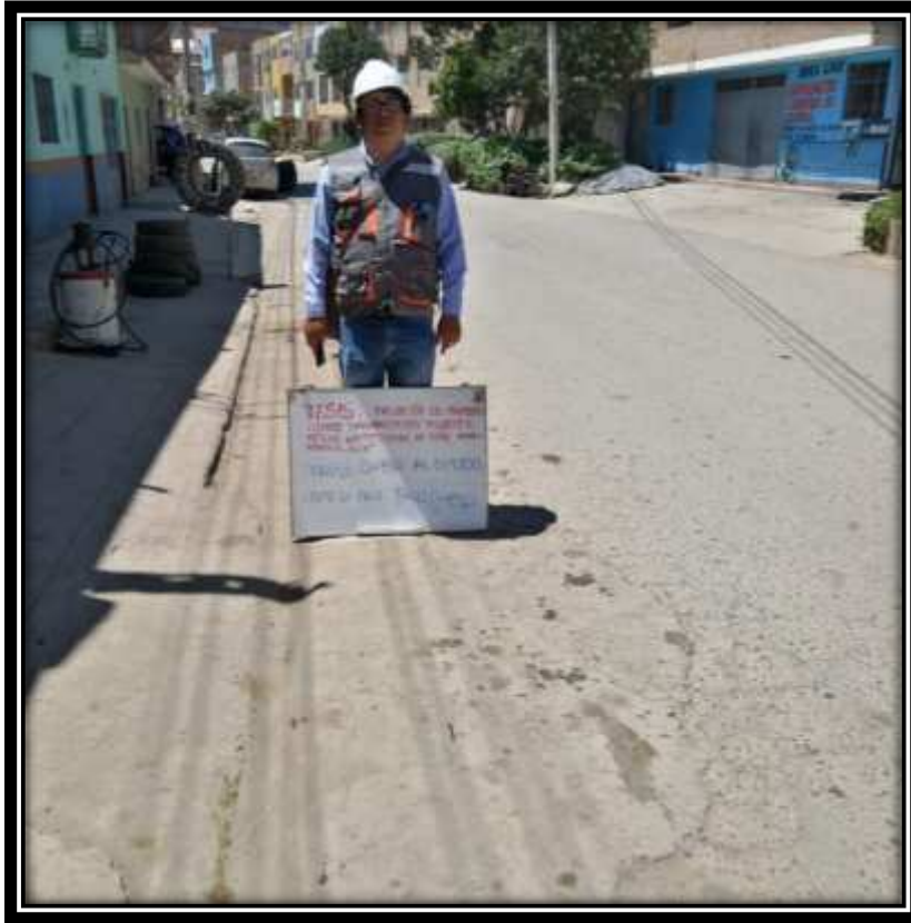
Foto N° 17: Tipo de falla: PARCHEO en el Km 0+750 al 0+1000
