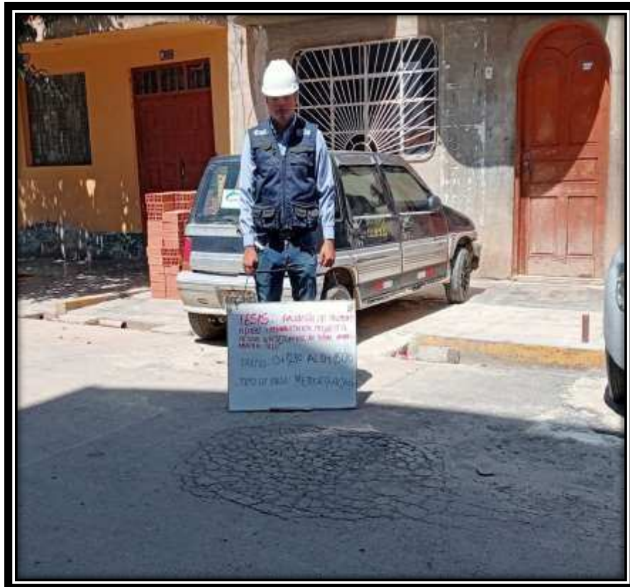
Foto N° 26: Tipo de falla: METEORIZACIÓN en el Km 0+1250 al 0+1500
