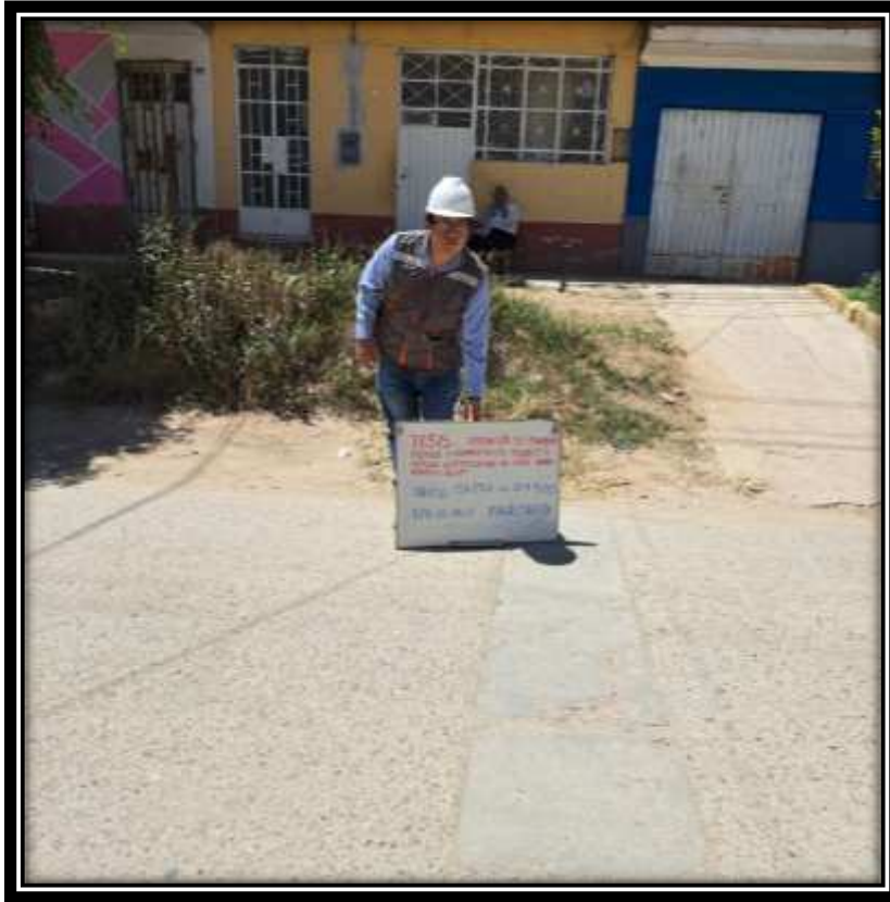
Foto N° 09: Tipo de falla: PARCHEO en el Km 0+250 al 0+500
