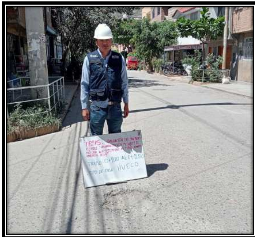
Foto N° 24: Tipo de falla: HUECO en el Km 0+1000 al 0+1250
