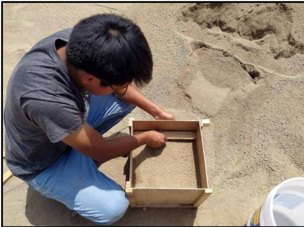
Figura N°15. Cubicación de arena gruesa para la proporción en arena de acuerdo al diseño de mezcla.
