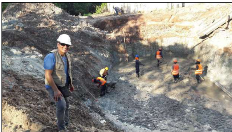
Fotografía 5.- Nivelación y perfilado de la zanja manual para la cimentación de estribos
