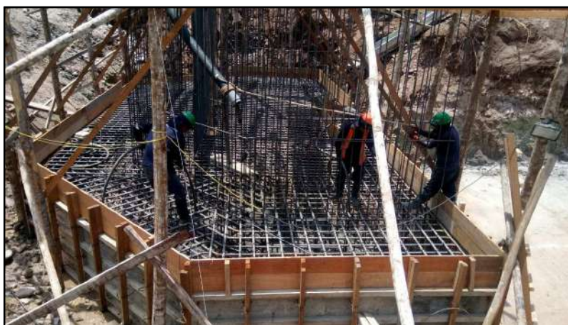
Fotografía 12.- Colocación de acero en la zapata y pantalla de estribos y aletas
