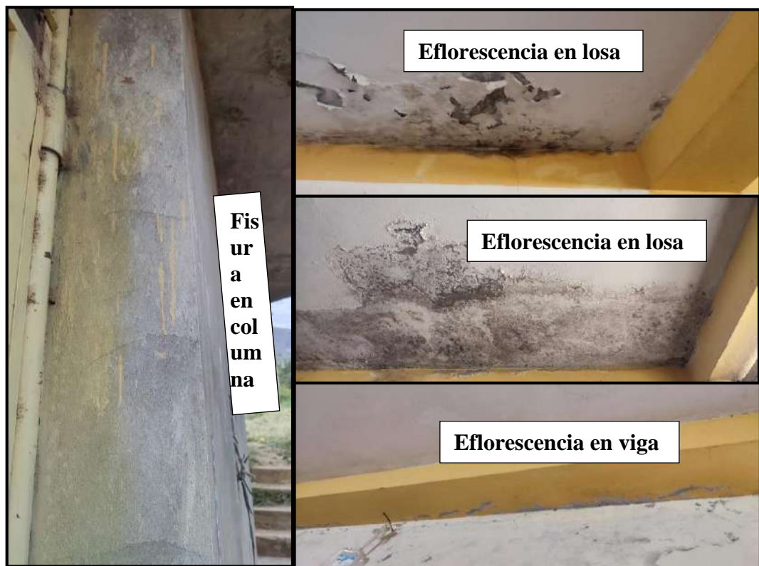
Fotografía 4.2 Patologías en elementos de concreto armado
