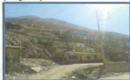
Presencia de viviendas asentadas sobre pircas, con amenaza de deslizamiento en caso de sismo (Imagen 13)
