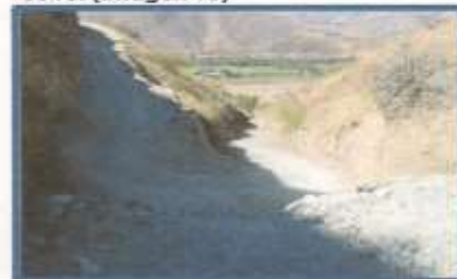
Erosión del suelo de la quebrada por parte de la actividad humana en la mencionada zona. (Imagen 12)
