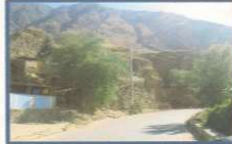
Se aprecia desprendimiento del suelo en la parte alta de la carretera. (Imagen 02)
