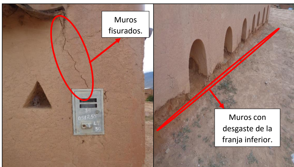
Ilustración 57: Muros fisurados, con desgaste de la franja inferior.
