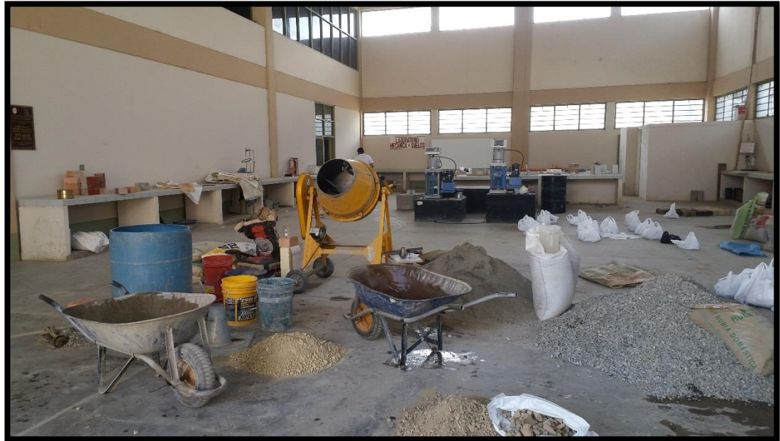
Fig. 28: En la vista se muestra el habilitado y iniciado de la elaboración del concreto
