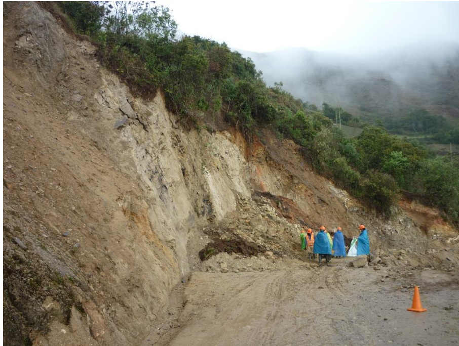
Fotografía N°13 – Se puede apreciar al personal de obra realizando los trabajos de limpieza de cunetas y el cono de seguridad para evitar la circulación de vehículos
