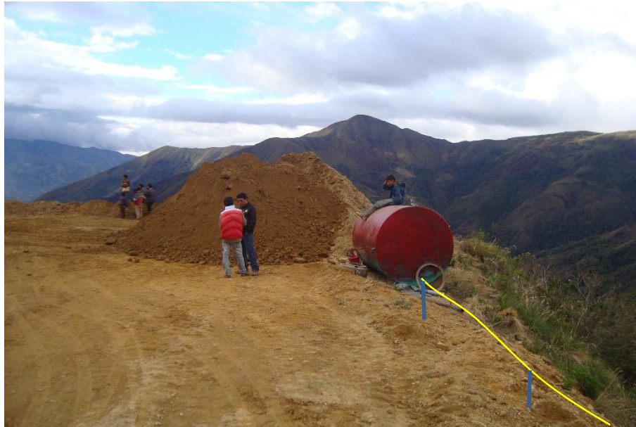
Fotografía N°03 – El Jefe de seguridad coordina las actividades antes de iniciar los trabajos en el día.
