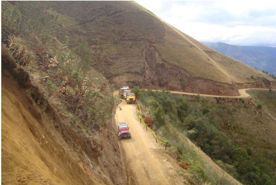
Fotografía N°05 – Se puede apreciar la ubicación de las unidades móviles de obra para dar pase a las unidades de servicio público.
