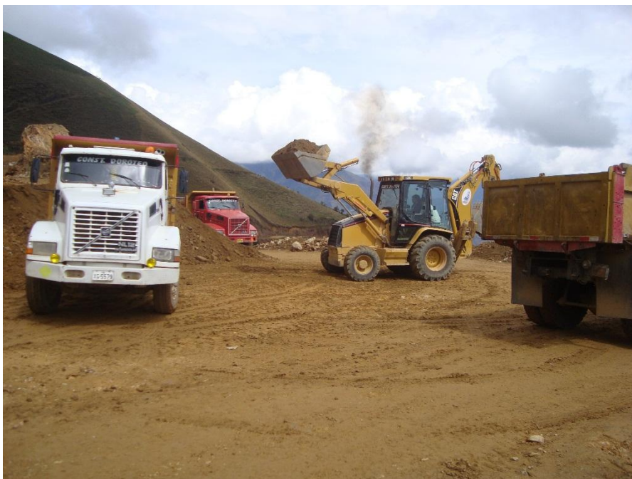
Fotografía N°08 – Se puede apreciar al personal de indicación y maniobras dirigiendo el proceso de carguío. .
