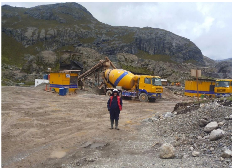
Se visualiza en la imagen la Planta de UNICON para el abastecimiento de concreto en la obra.
