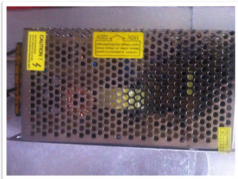
Fotografía 4: Instalación de la fuente de poder.
