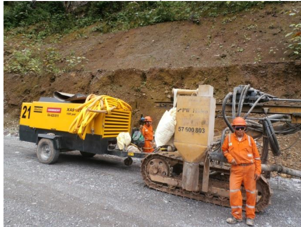
Imagen N° 2.24: Compresora Atlas Copco.
