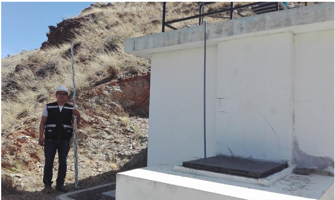
Figura 20. Ubicación del tanque reservorio - en huachog
