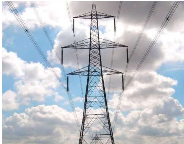
Fig. 2.3: Torre de alta tensión de suspensión.
