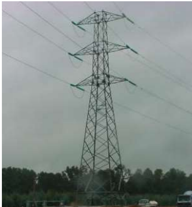
Fig. 2.4: Torre de alta tensión de anclaje.
