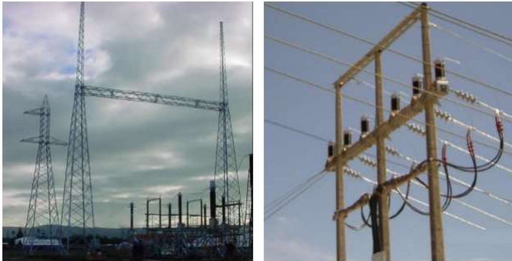
Fig. 2.4: Torre de alta tensión de remate.
