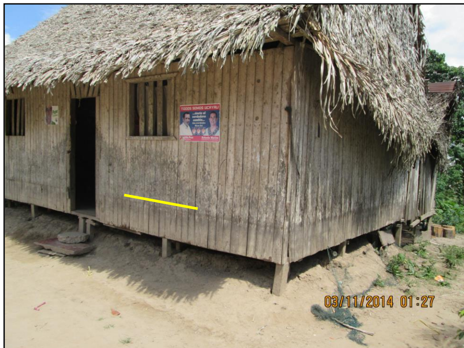
Figura Nº 26: Altura de máxima inundación en el caserío Éxito.
