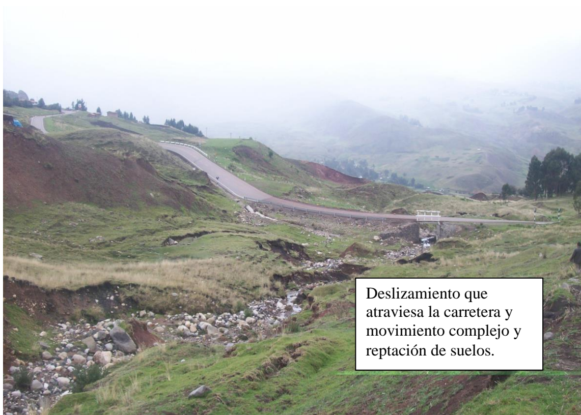
Foto N° 06. Puente Challhuamayo: por el cuál atraviesa el umbral por la carretera asfaltada Huancavelica-Izcuchaca el deslizamiento provocadas por la saturación del suelo que viene desde las laderas de la laguna de Tontoccocha.
