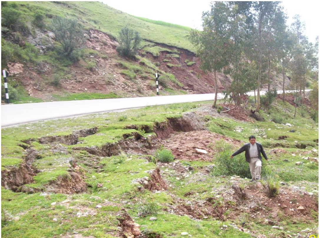
Foto N° 05. Movimiento de masa de suelo en las partes adyacentes de la carretera Km 65+680, ubicado en el sector I de la comunidad de Antacocha.
