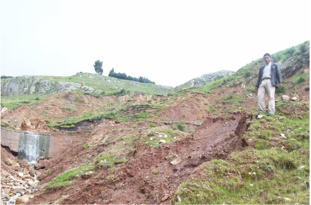
Foto N° 10. Elaboración propia, activación de la quebrada por socavación que afecta las bermas de la carretera, ubicada en el sector I de la comunidad de Antacocha.
