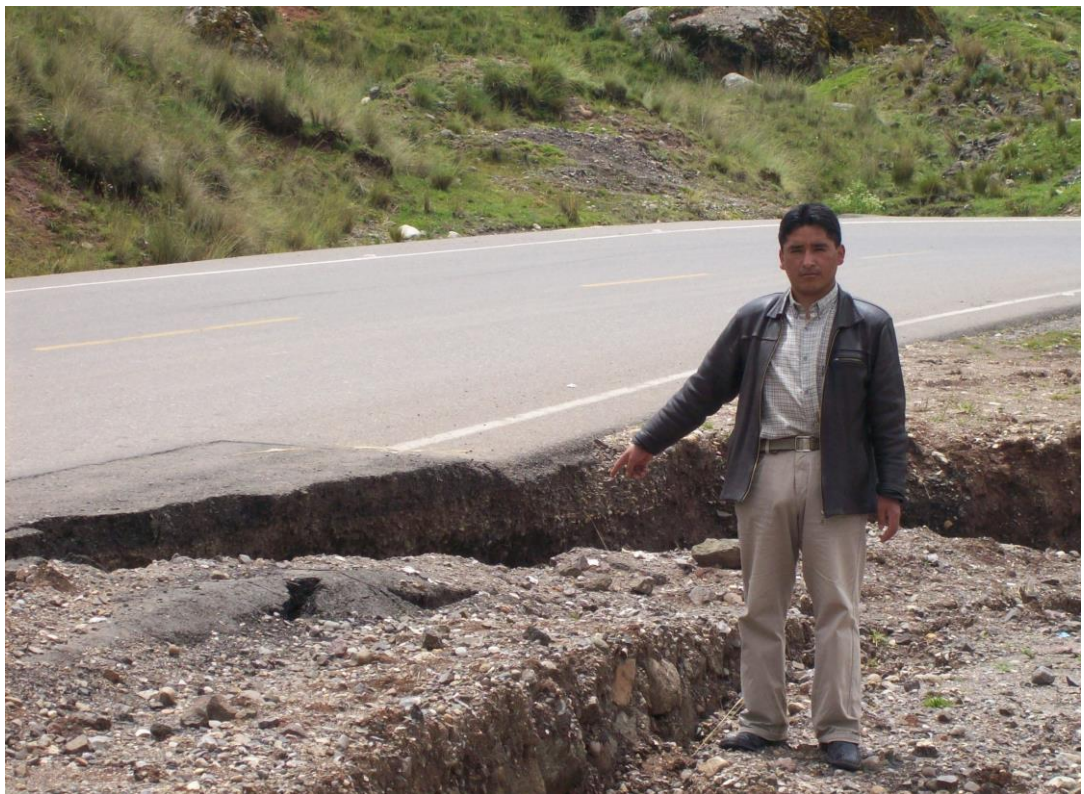
Foto N° 08: Elaboración propia, fractura de la berma y plataforma de la carretera, ubicada en el sector II de la comunidad de Antacocha.
