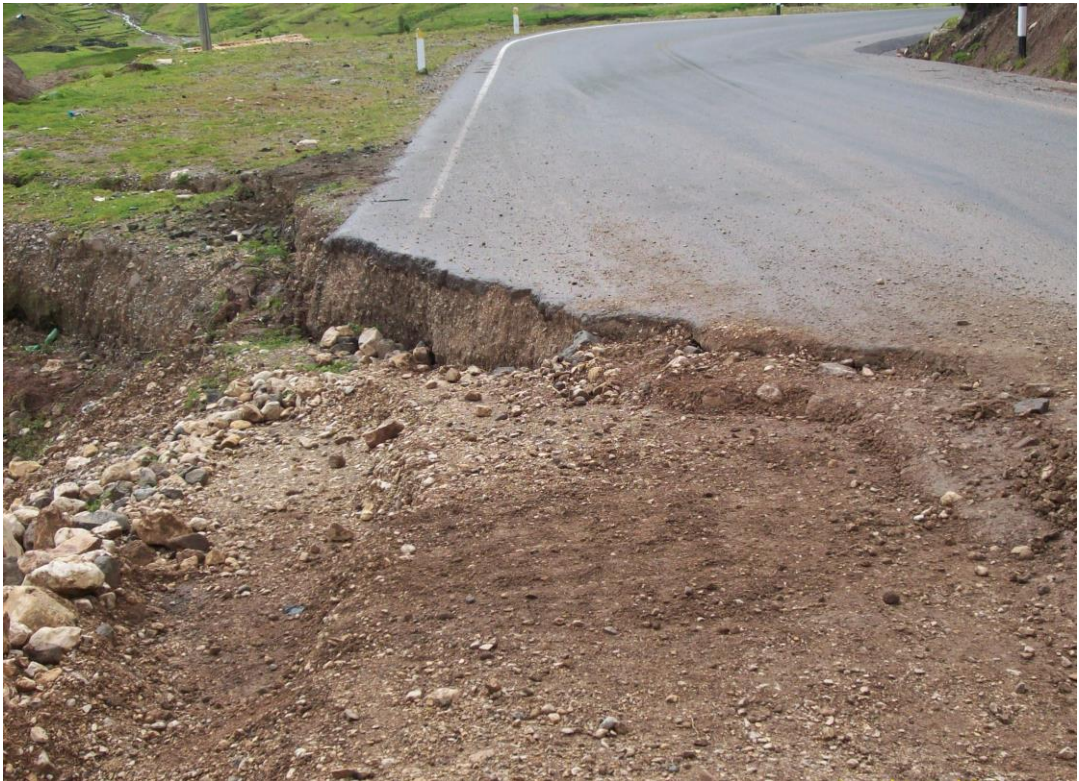
Foto N° 09: Elaboración propia, hundimiento de la plataforma de la carretera y una parte del terreno, ubicada en la comunidad de Huayllaracca.
