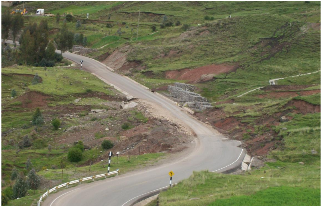
Foto N° 01: elaboración propia, deslizamiento de masa de suelo en Km 64+240, se observa cunetas y plataforma de la carretera en movimiento, ubicada en el sector II de la comunidad de Antacocha.
