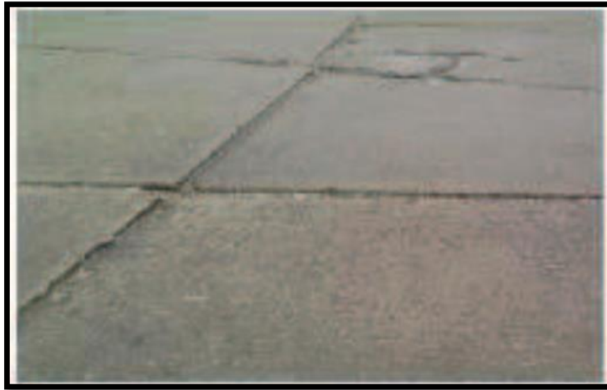
FIGURA 30: gravedad 2; reducción significativa de la velocidad
