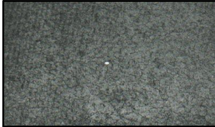
FIGURA 19: Desconchamiento de baja severidad
