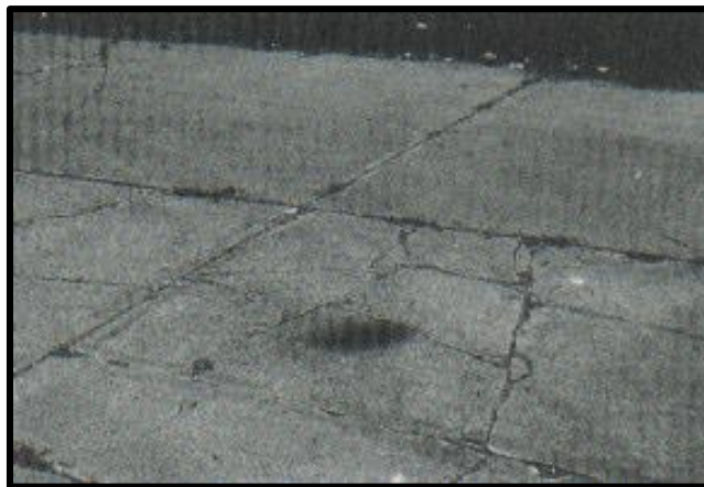
FIGURA 3: Losa dividida de alta severidad
