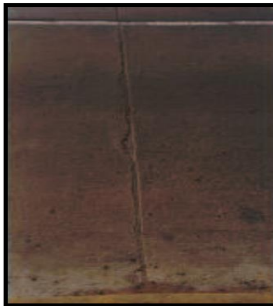
FIGURA 45: despostillamiento de juntas menor
