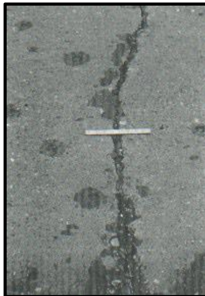
FIGURA 8: Grietas lineales de severidad media en losa de concreto reforzado
