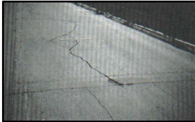
FIGURA 2: Losa dividida de severidad media.
