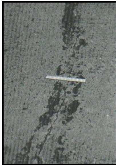
FIGURA 7: Grietas lineales de baja severidad en losa de concreto simple
