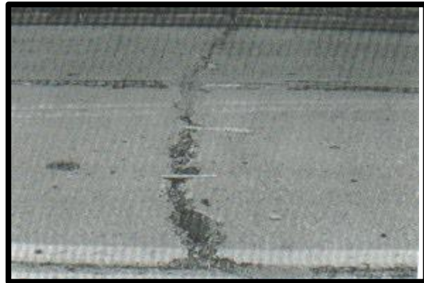
FIGURA 9: Grietas lineales de alta severidad en losa de concreto simple
