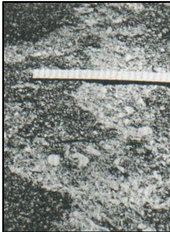
FIGURA 20: Desconchamiento de severidad media
