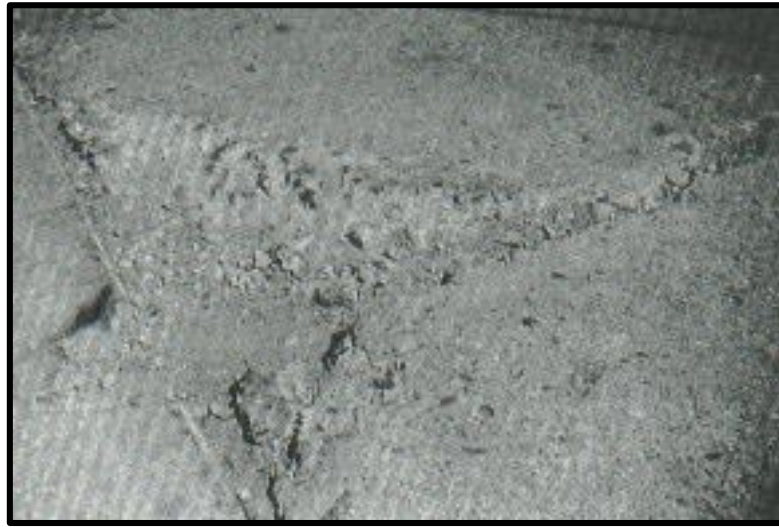
FIGURA 24: Descascaramiento de alta severidad
