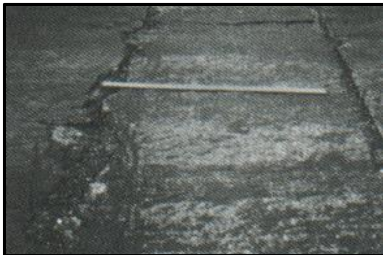
FIGURA 12: Parche grande de alta severidad
