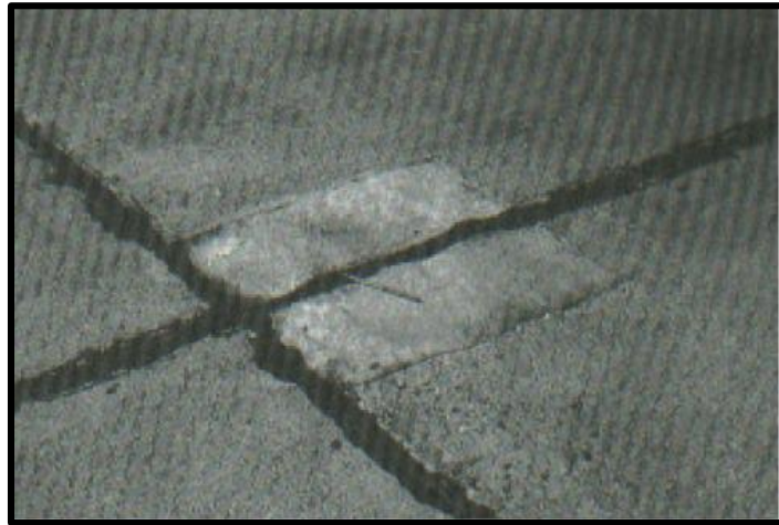
FIGURA 13: Parche pequeño de baja severidad
