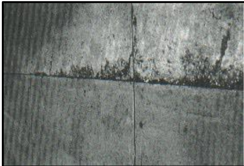
FIGURA 26: Descascaramiento de junta de severidad media
