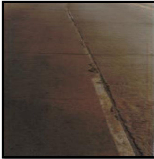
FIGURA 46: despostillamiento de juntas medias
