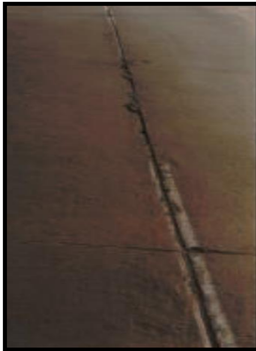
FIGURA 47: despostillamiento de juntas mayor
