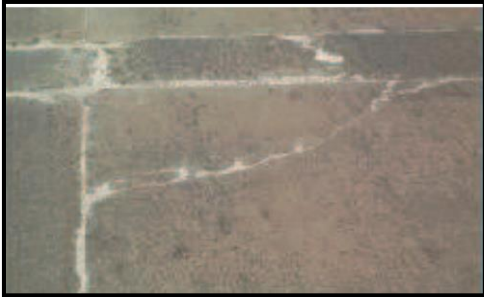
FIGURA 41: Fisuras oblicuas gruesas
