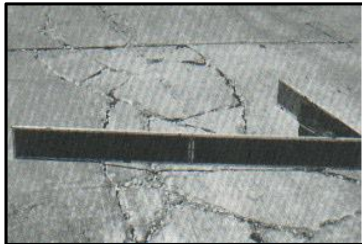
FIGURA 18: Punzonamiento de alta severidad
