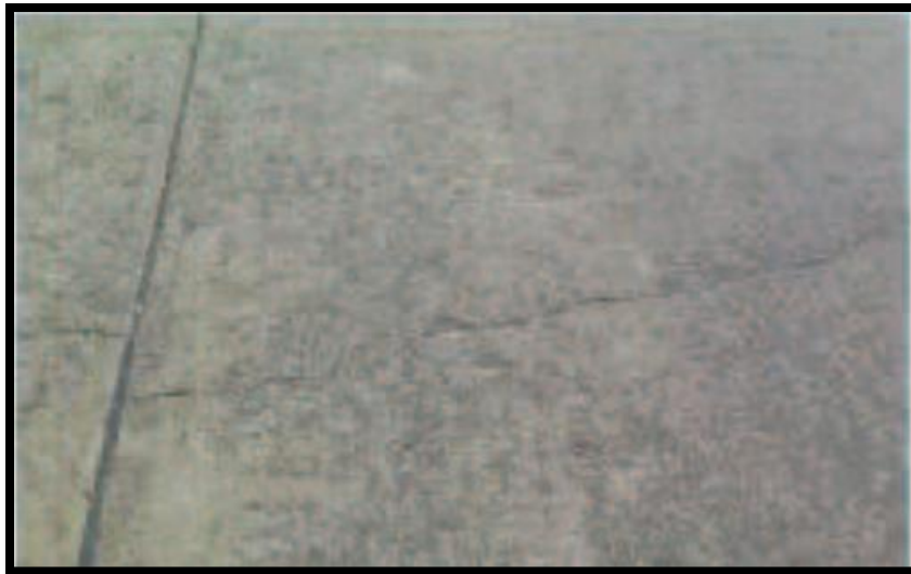
FIGURA 39: Fisuras oblicuas finas
