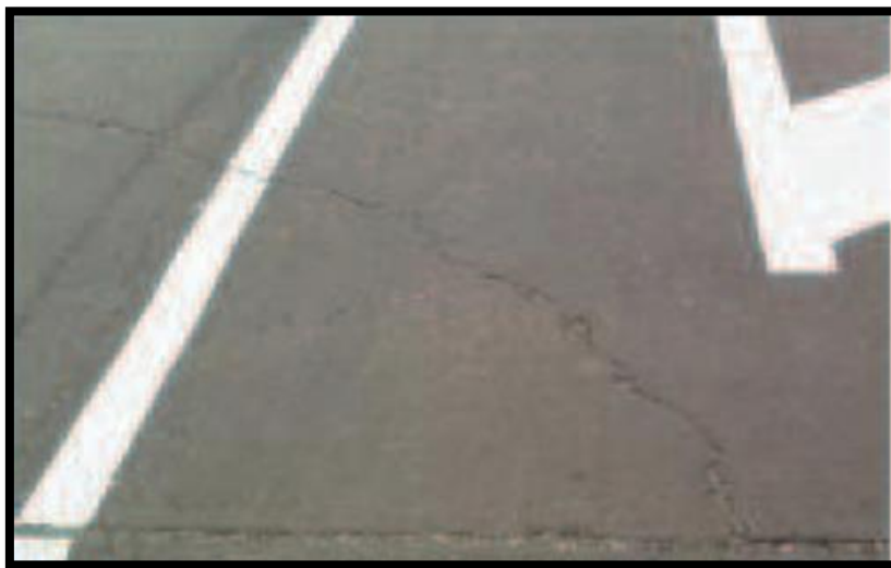
FIGURA 40: fisuras oblicuas medias
