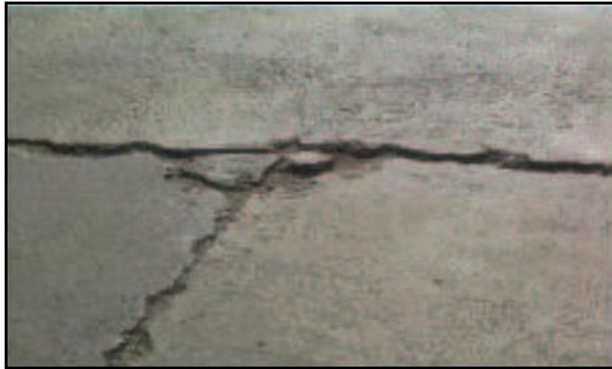
FIGURA 38: dos esquinas quebradas
