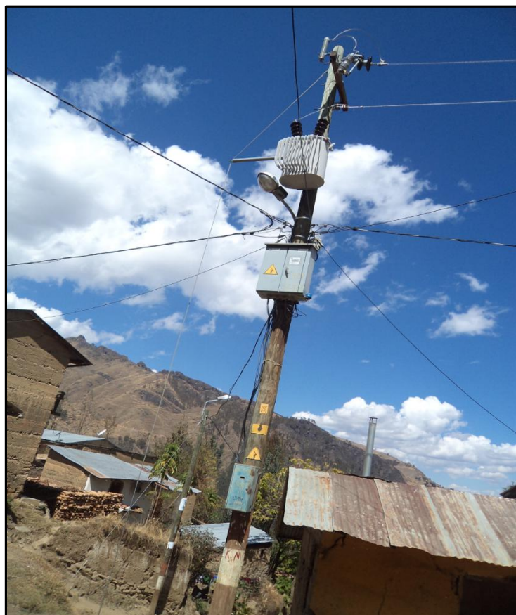
Fotografía N° 012: Vista del transformador de energía eléctrica en la Localidad de Marías
