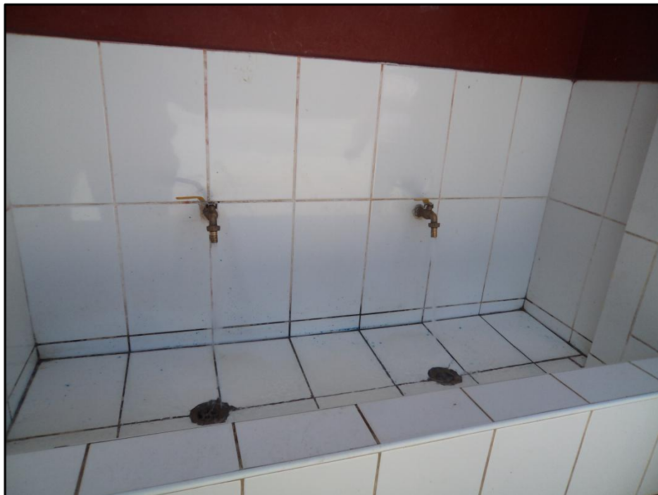
Fotografía N° 02: Vista de los caños con fluido del agua potable – localidad de Marías
