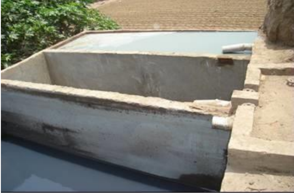
Foto 3.- Pozas de tratamiento de residuales líquidos Cueros Tauro – Huachipa, Set. 17
