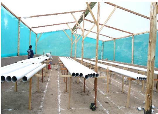
Fig. N° 24. Tubos de PVC.
