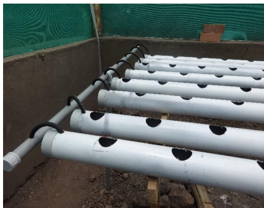
Fig. N° 27. Mangueras para la recirculación de la solución
