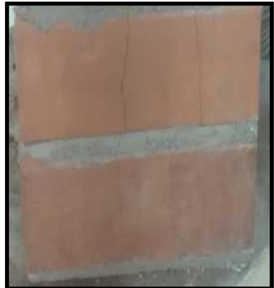
Figura 29. Falla por fisuras verticales – Semi industrial.
