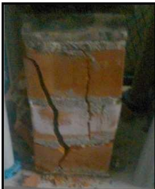
Figura 48. Falla por trituración y fisura vertical vista frontal - Artesanal.
