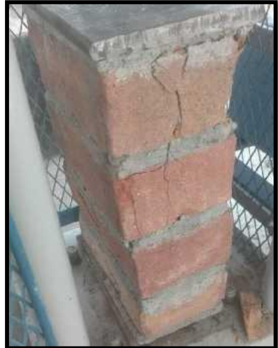
Figura 33. Fisura vertical vista frontal – Artesanal.
