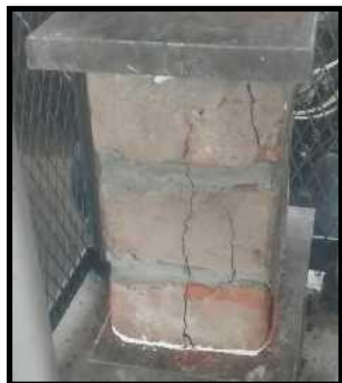
Figura 31. Fisura vertical vista frontal – Artesanal.
