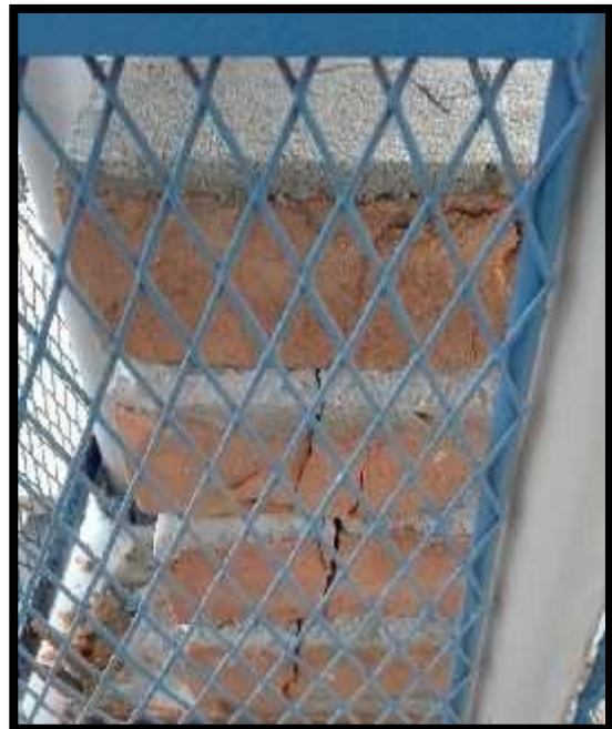
Figura 47. Falla por trituración y fisura vertical vista lateral - Artesanal.
