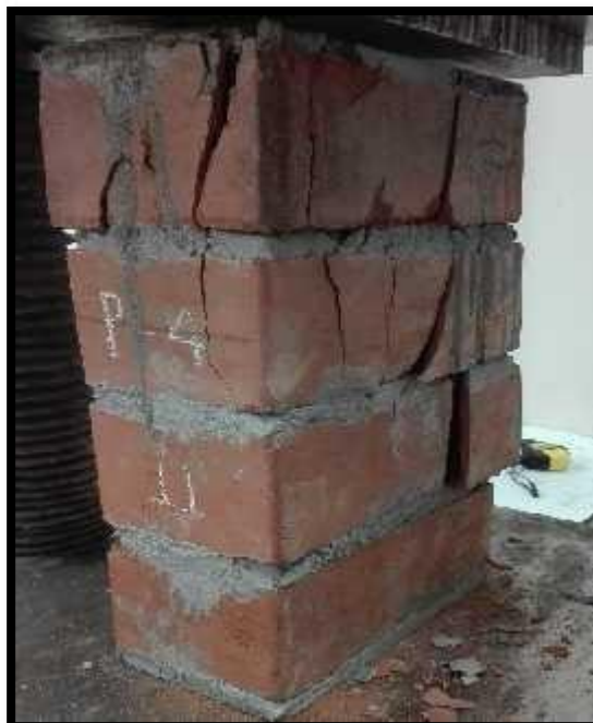
Figura 42. Falla por trituración vista frontal – Semi industrial.
