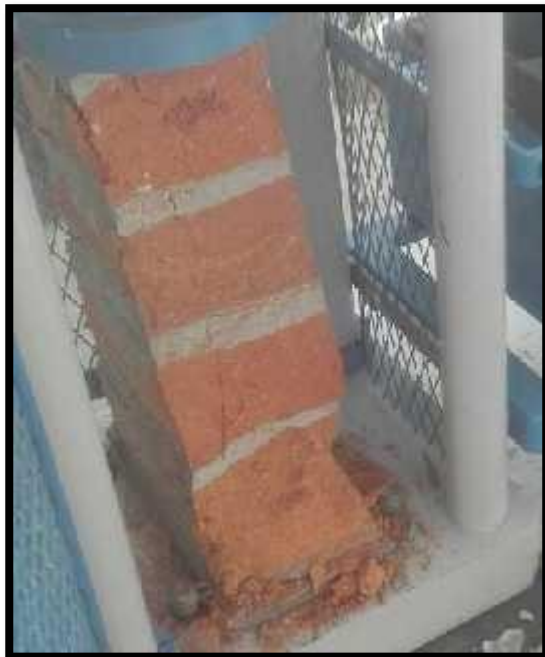
Figura 46. Falla por trituración y fisura vertical vista frontal - Artesanal.
