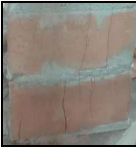
Figura 28. Falla por Fisuras verticales – Semi industrial.
