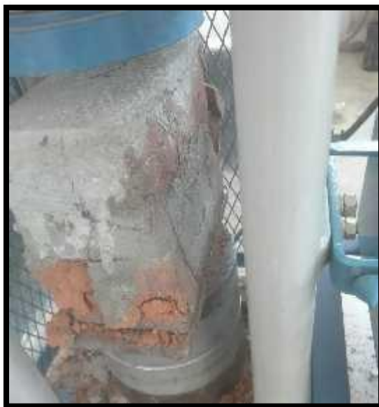
Figura 26. Falla por aplastamiento – Artesanal.
