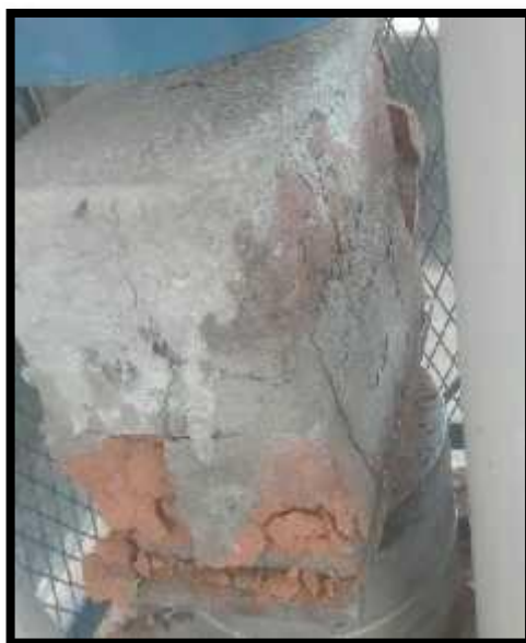
Figura 38. Falla por trituración vista frontal – Artesanal.
