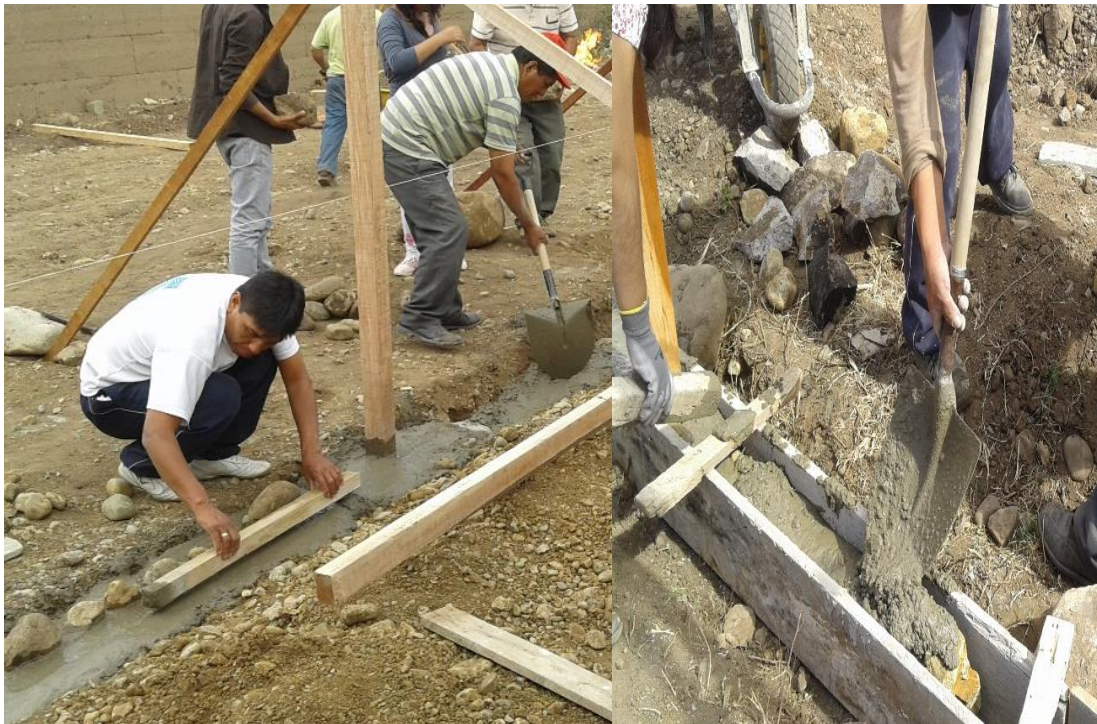
Figura 66. a) Llenado del cimiento y colocación de los postes. b) Vaciado del sobre cemento.
