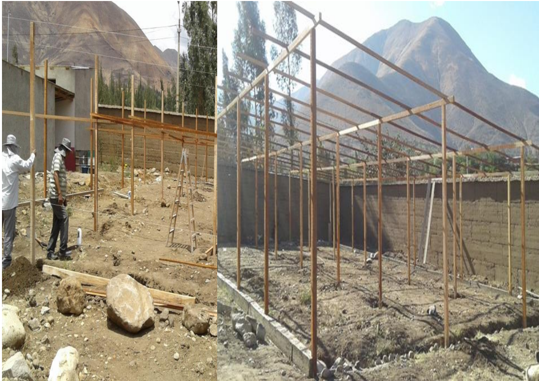
Figura 67. Estructura principal del cobertor.
