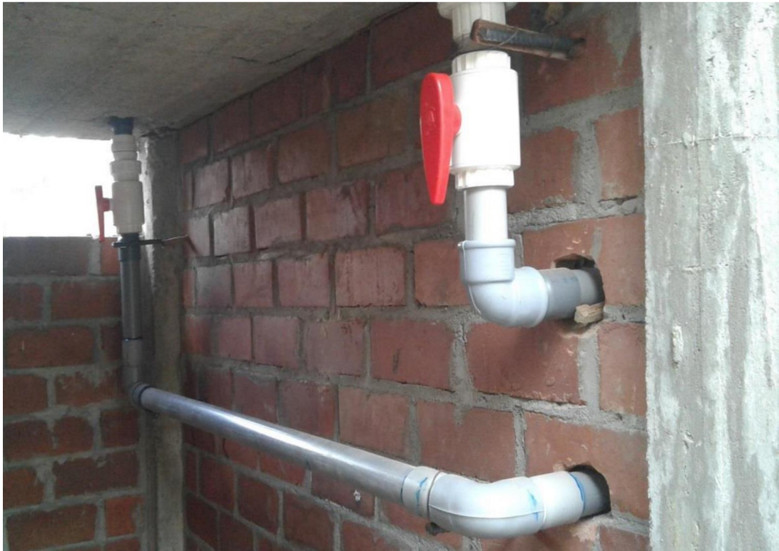
Figura 71. Llaves de paso principales del sistema de riego.
