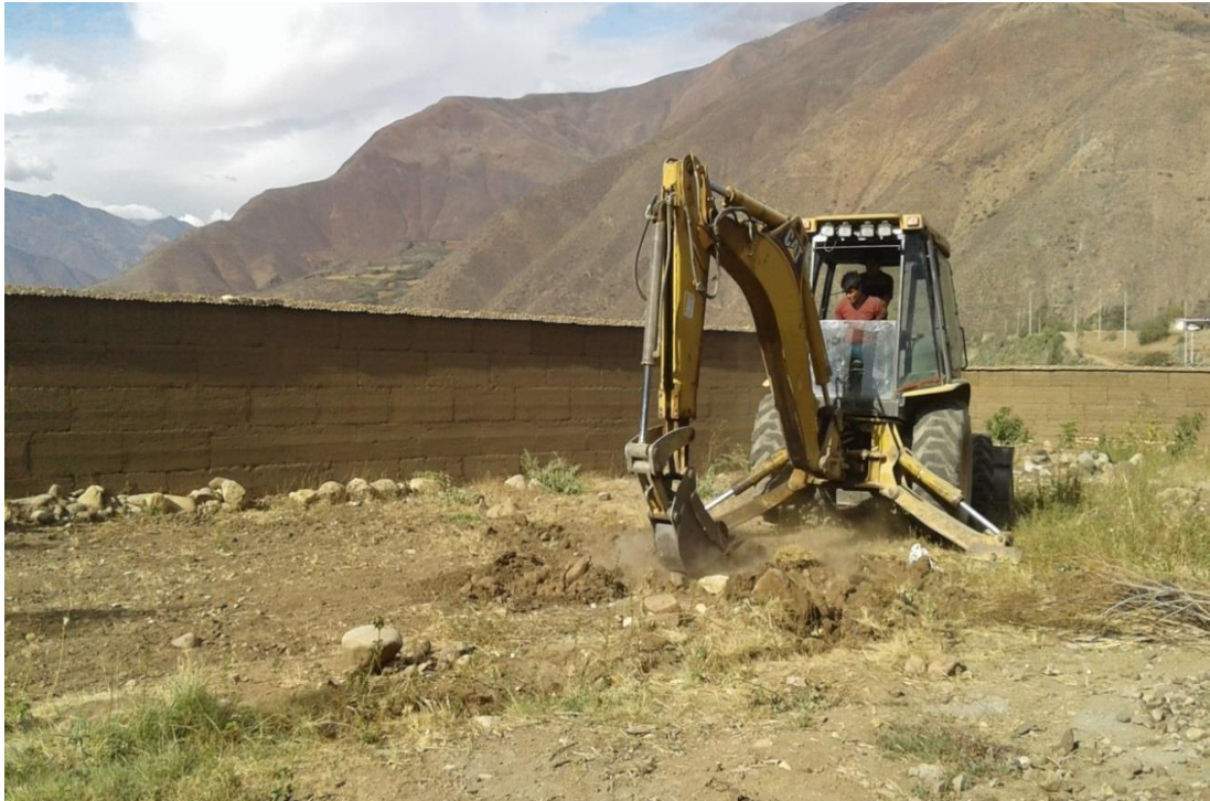
Figura 65. Se aprecia en esta imagen el proceso de remoción para la instalación del cobertor.
