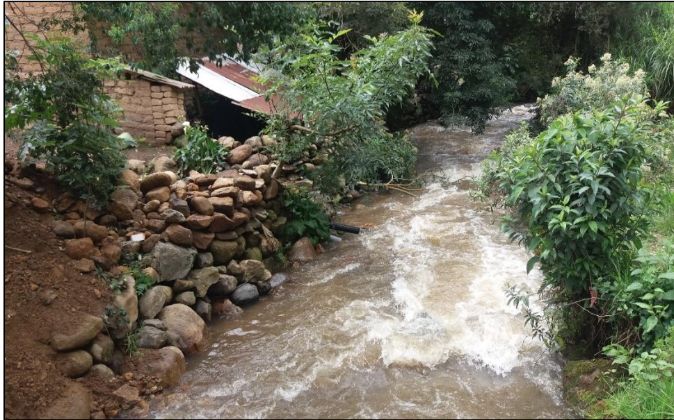
Foto N° 03: Viviendas en peligro de colapso por inundación.
