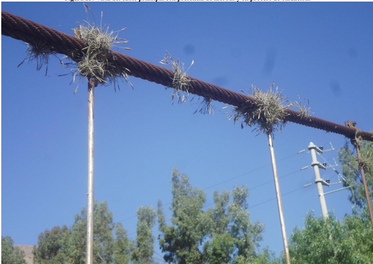
Figura 23: Vista del cable principal con presencia de hierbas y en proceso de oxidación.
