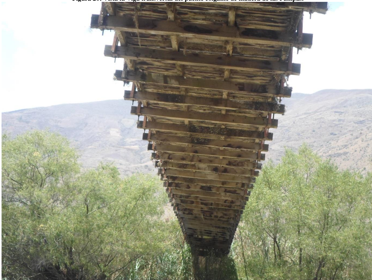
Figura 20: Vista la Viga transversal del puente colgante de madera de las Pampas.
