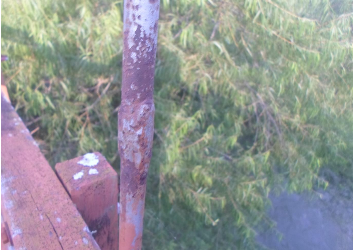
Figura 26: Vista de péndola reparada en proceso de oxidación.
