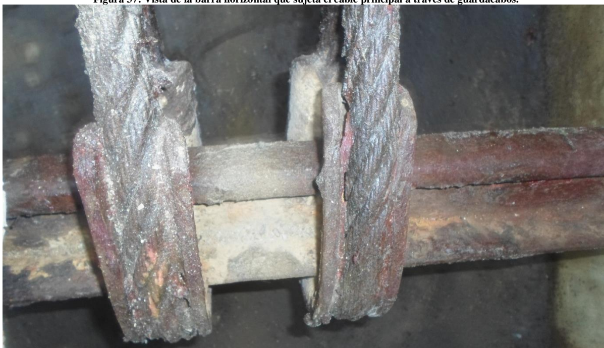
Figura 37: Vista de la barra horizontal que sujeta el cable principal a través de guardacabos.
