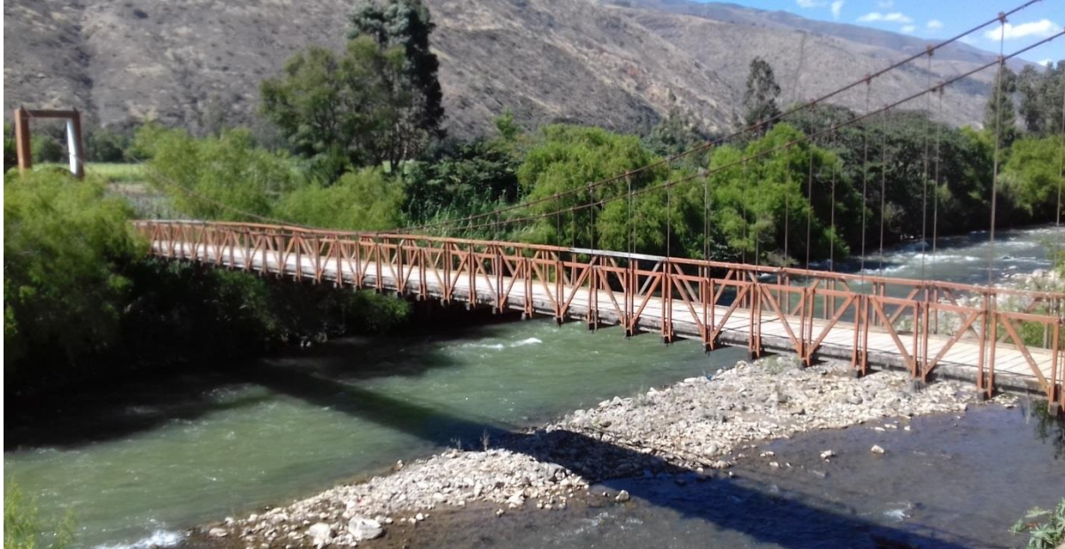
Figura 22: Acumulación de material de arrastre bajo el puente colgante de madera de las Pampas.
