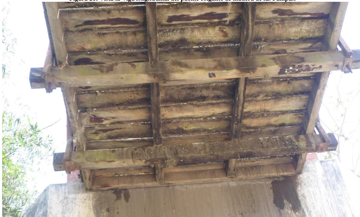
Figura 21: Vista la Viga longitudinal del puente colgante de madera de las Pampas.
