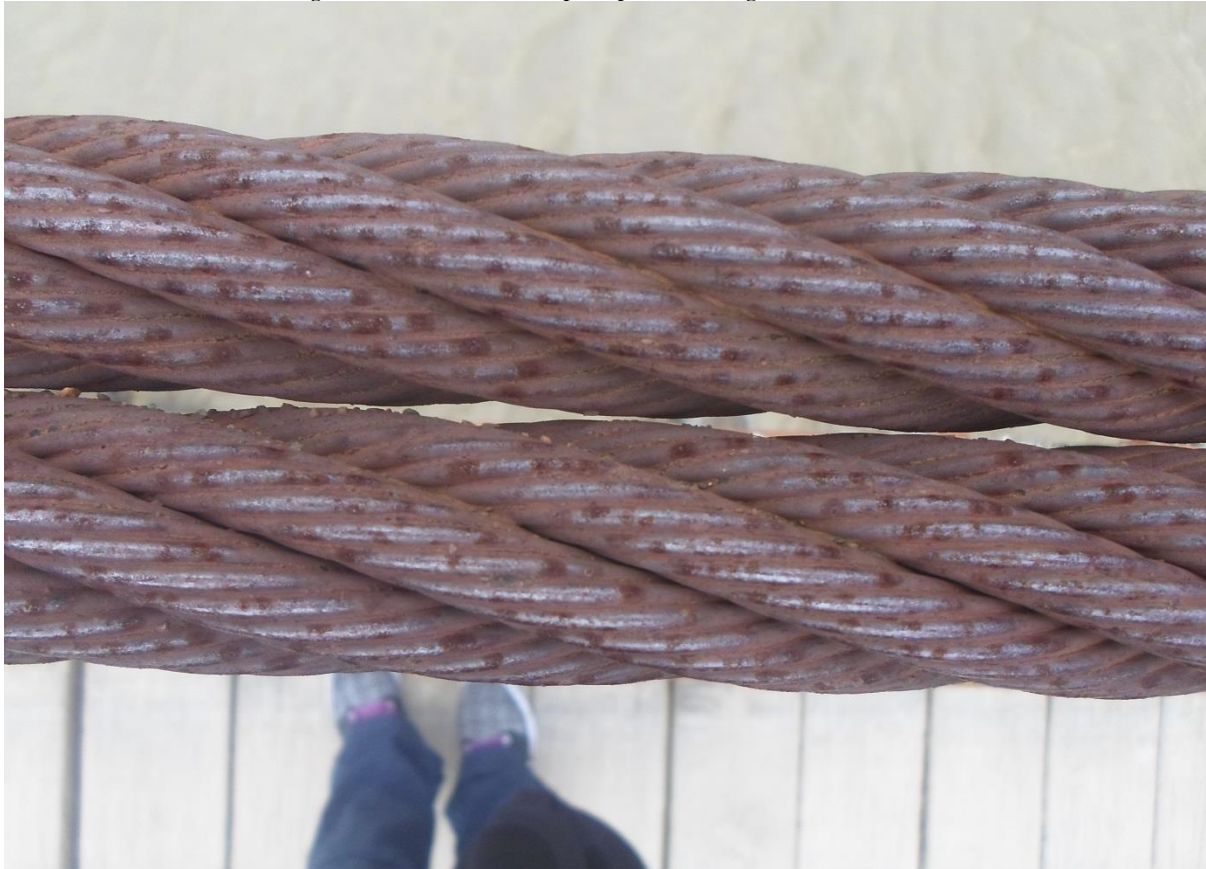
Figura 24: Vista de los cables principales con alto grado de oxidación
