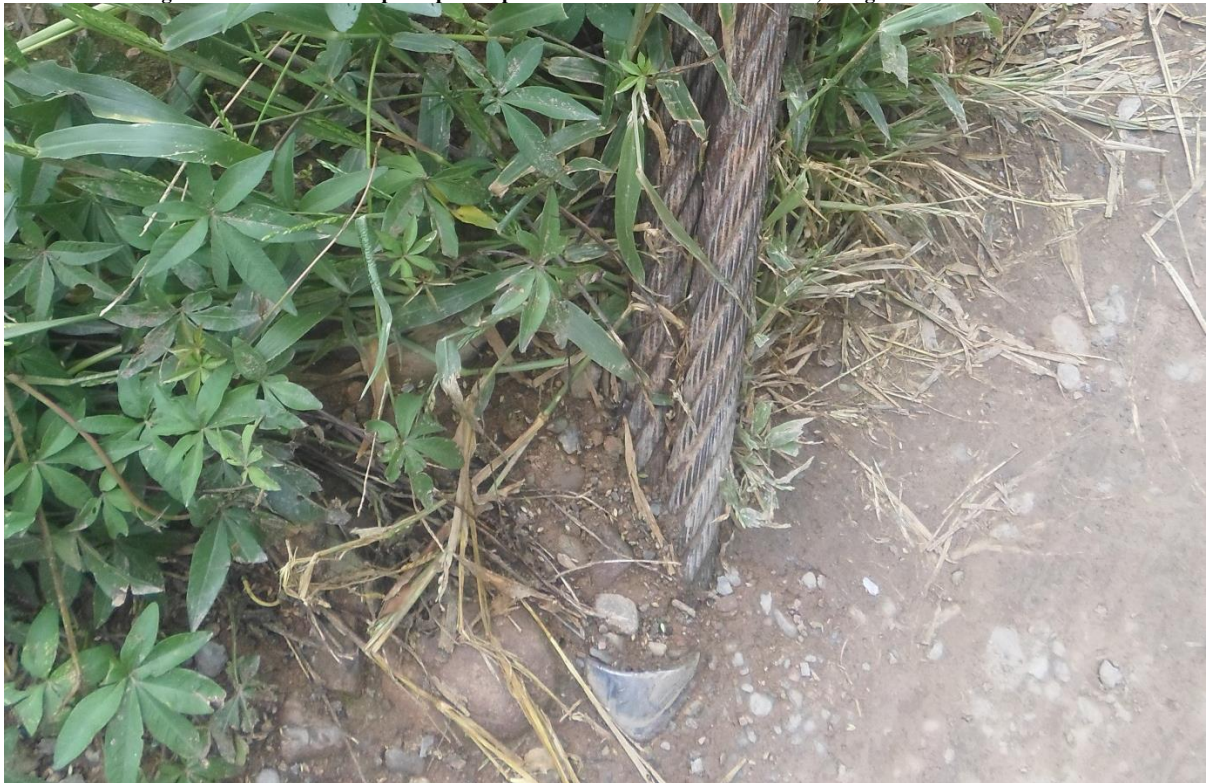
Figura 25: Vista del cable principal sin protección en contacto con el suelo, margen derecha rio arriba
