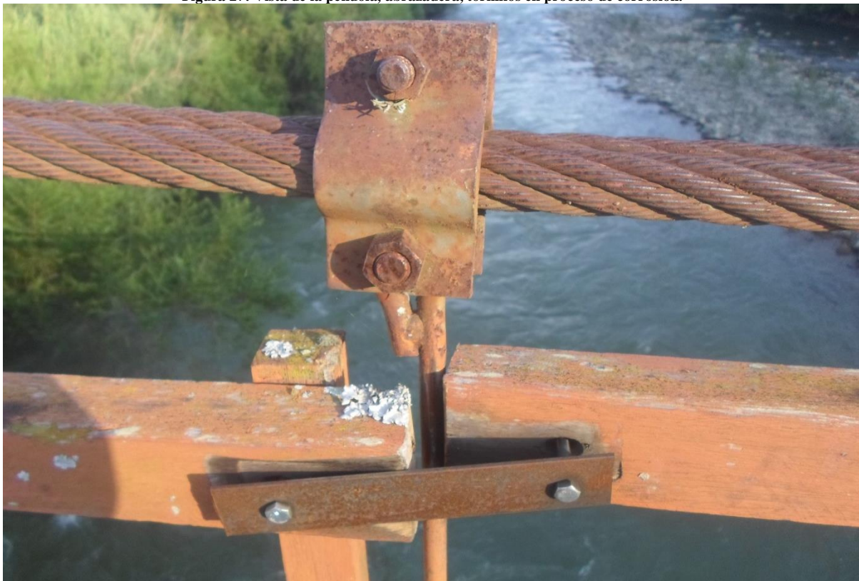
Figura 27: Vista de la péndola, abrazadera, tornillos en proceso de corrosión.
