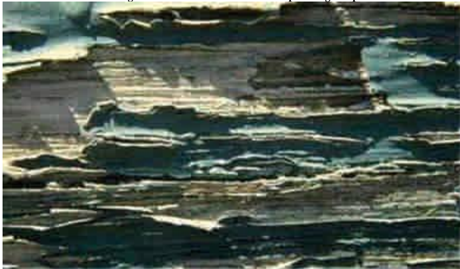
Figura 49: Pieza de madera atacada por hongo de pudrición.
