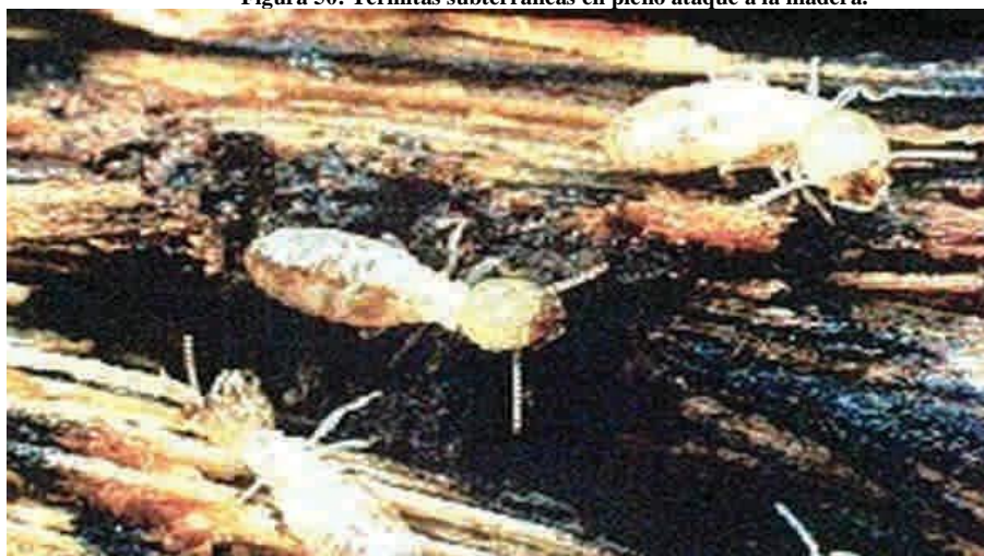
Figura 50: Termitas subterráneas en pleno ataque a la madera.
