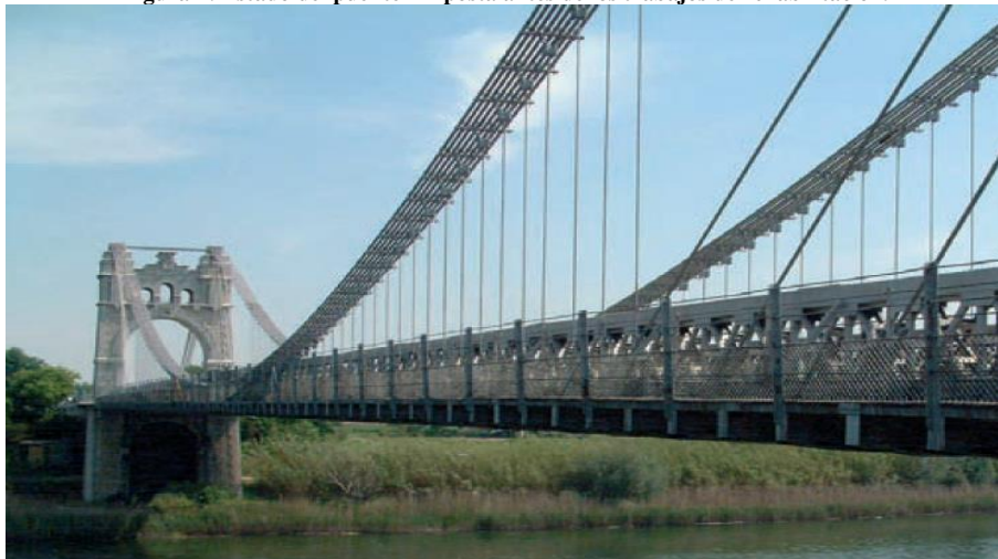
Figura 1: Estado del puente Amposta antes de los trabajos de rehabilitación.
