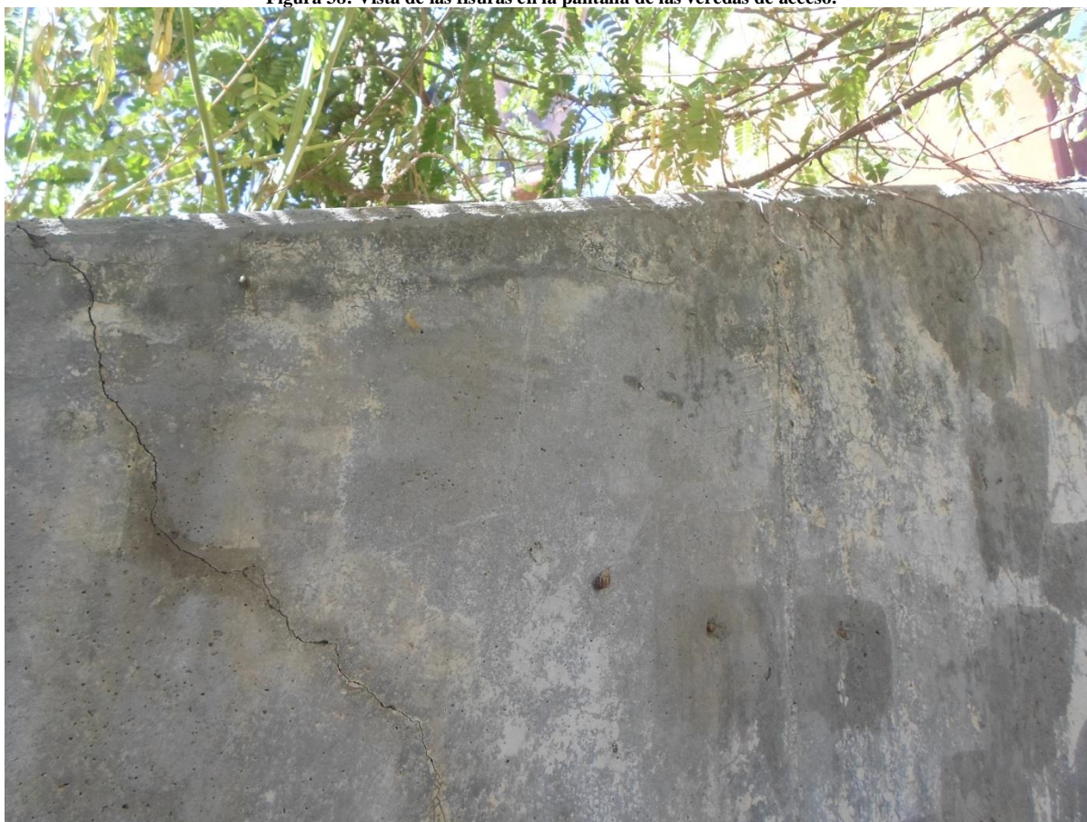
Figura 38: Vista de las fisuras en la pantalla de las veredas de acceso.
