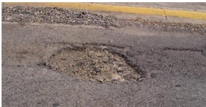
Figura 3. Bache en pavimento flexible.
