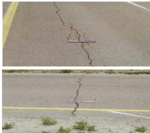
Figura 4. Fisura en pavimento flexible.
