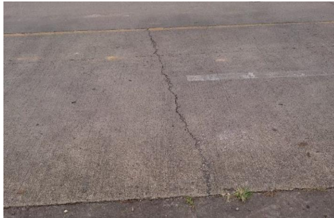
Figura 8. Grieta transversal en el pavimento rígido.
