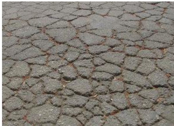
Figura 6. Piel de cocodrilo en pavimento flexible.
