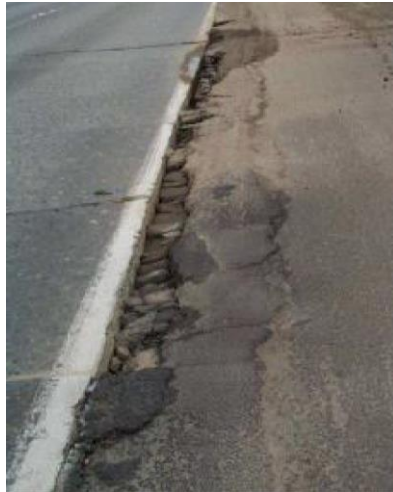
Figura 12. Erosión por bombeo en pavimento rígido.
