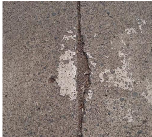
Figura 14. Despostillamientos de juntas en pavimento rígido.
