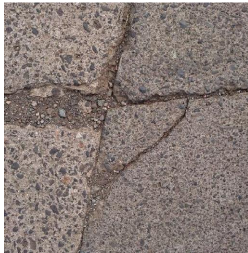
Figura 11. Rotura en esquinas en pavimento rígido.
