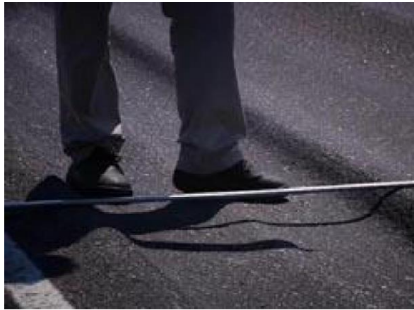
Figura 7. Ondulaciones en pavimento flexible.
