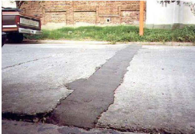
Figura 13. Escalonamiento en pavimento rígido.
