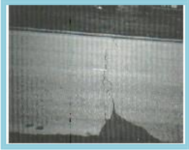
Figura 12: Grietas longitudinales y transversales.
