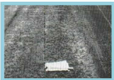
Figura 21 Meteorización/desprendimiento de agregados
