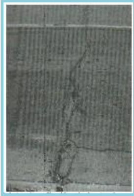
Figura 10: Grieta de reflexión de junta.
