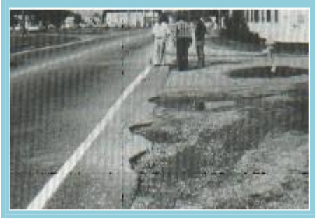
Figura 9: Grieta de borde.
