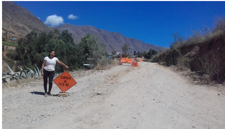
Gráfico 17: Colocación de Señales de Seguridad
