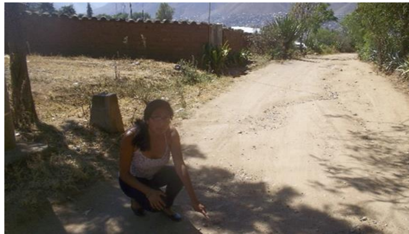
Gráfico 8: Deterioro en el Sector B
