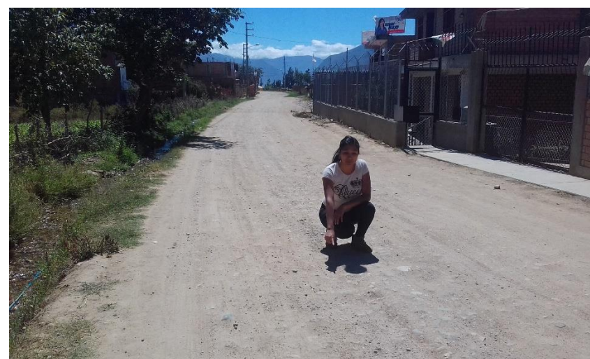
Gráfico 9: Deterioro en el Sector C
