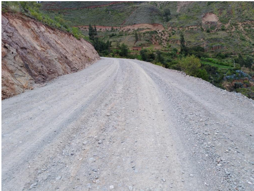
Fotografía 17. Verificación de pérdida de agregado - Sector II
