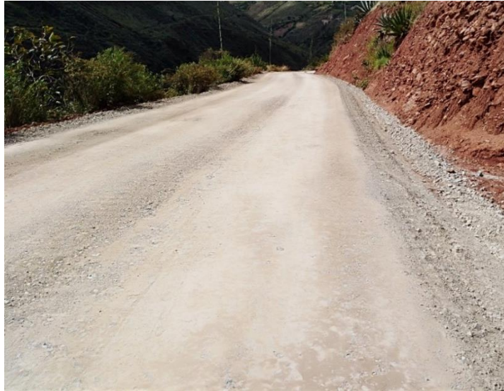
Fotografía 4.6. Sin presencia de encalaminado
