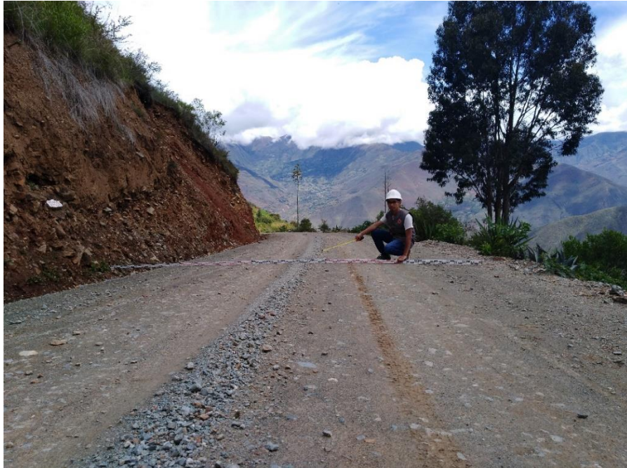
Fotografía 18. Verificación de pérdida de agregado - Sector III
