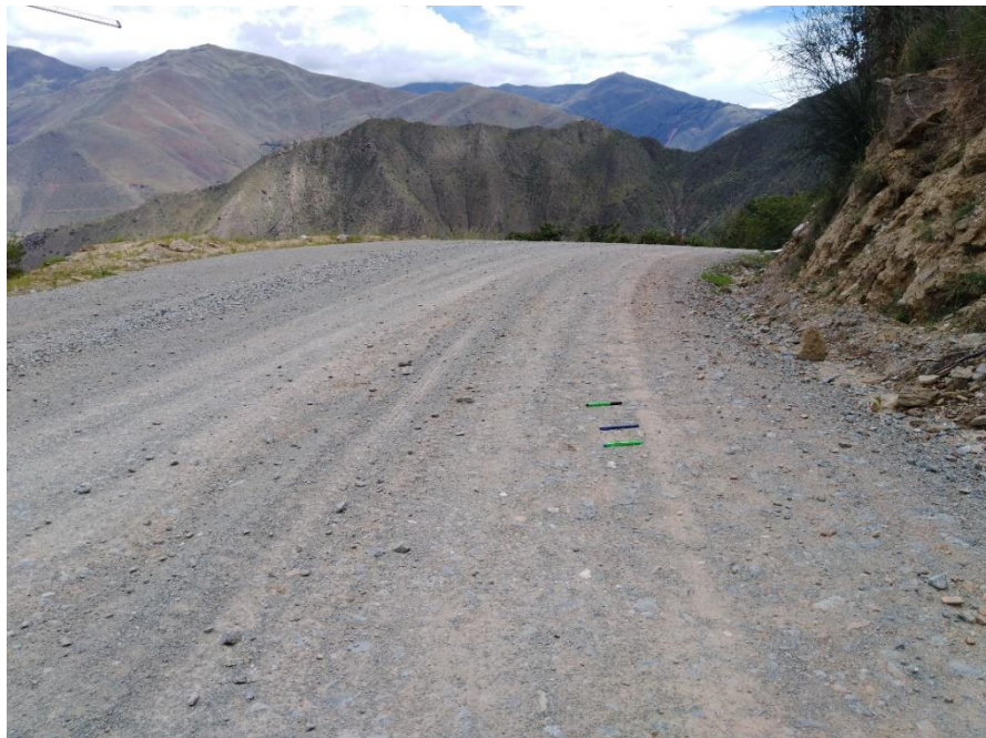
Fotografía 16. Verificación de pérdida de agregado - Sector I
