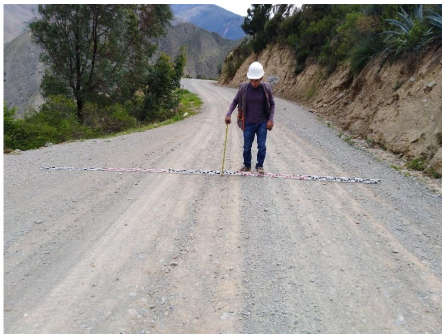
Fotografía 10. Medición del ahuellamiento – Sector I
