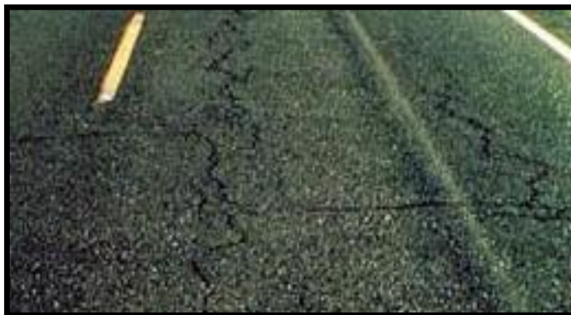
Figura N°47. Grieta longitudinal transversal nivel M
