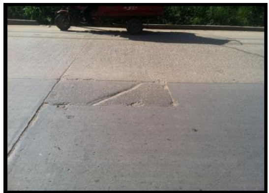
Foto N° 04: Deterioro de parche
