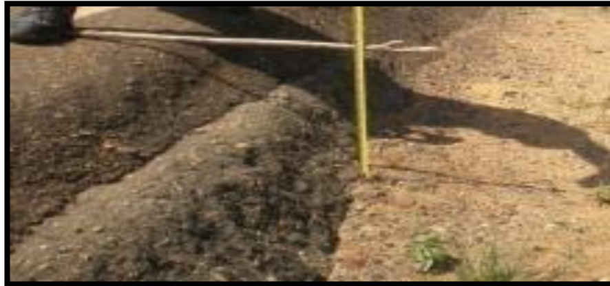
Figura N° 45. Desnivel calzada-hombrillo nivel H.
