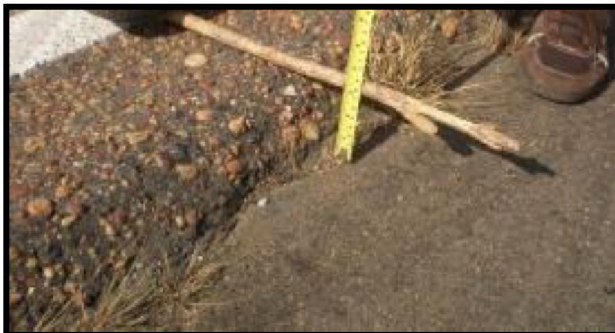
Figura N° 44. Desnivel calzada-hombrillo nivel M
