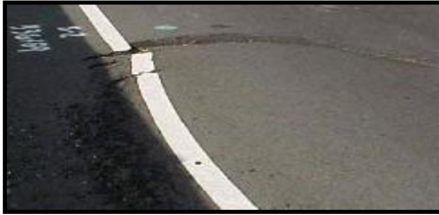
Figura N° 64. Grietas por desplazamiento nivel M
