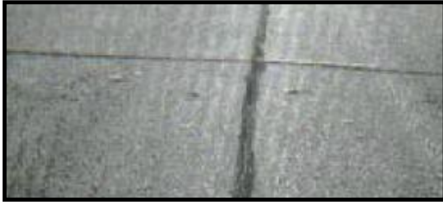
Figura N°41. Grieta de reflexión de junta nivel M
