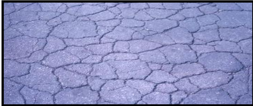
Figura N°21. Piel de cocodrilo nivel H
