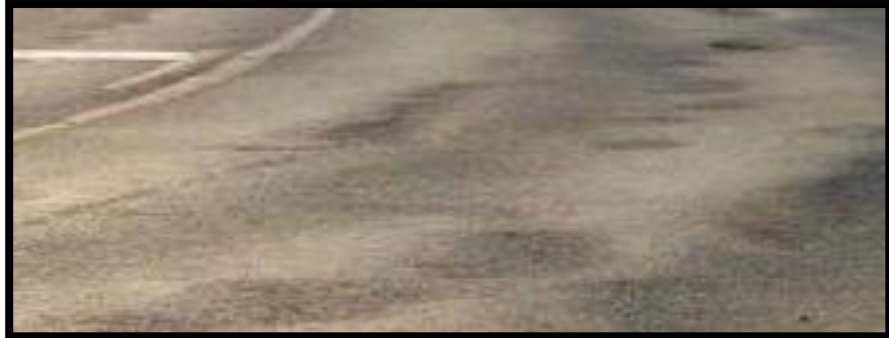
Figura N° 61. Deformación por empuje nivel M
