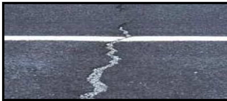
Figura N° 48. Grieta longitudinal transversal nivel H
