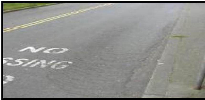
Figura N° 63. Grietas por desplazamiento nivel L
