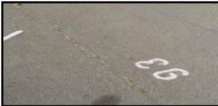
Figura N°40. Grieta de reflexión de junta nivel L
