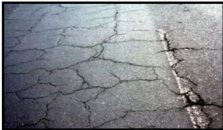
Figura N° 26. Grieta de contracción nivel M
