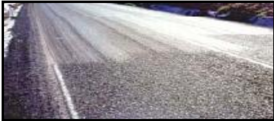
Figura N°67. Disgregación y desintegración nivel L
