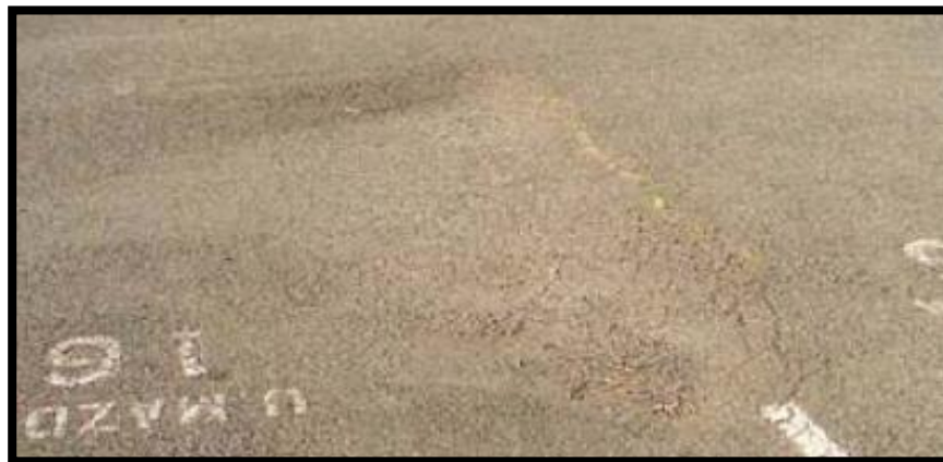
Figura N° 29. Elevación y/o hundimiento nivel M
