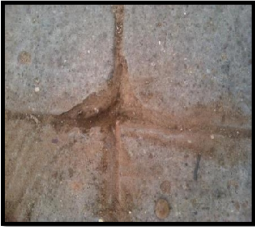
Foto N° 07: Esquinera severidad alta
