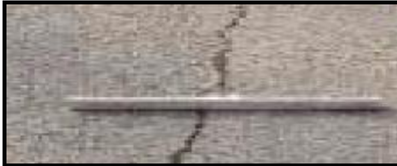
Figura N° 38. Grieta de borde nivel M
