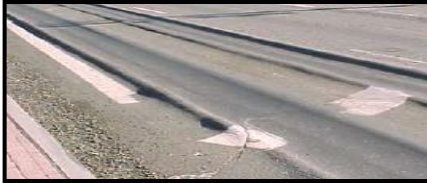
Figura N° 59. Profundidad de ahuellamiento.
