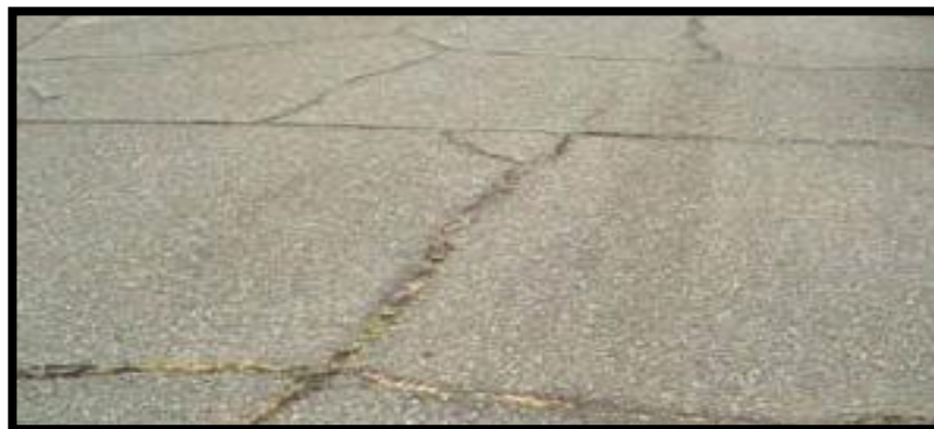
Figura N° 42. Grieta de reflexión de junta nivel H
