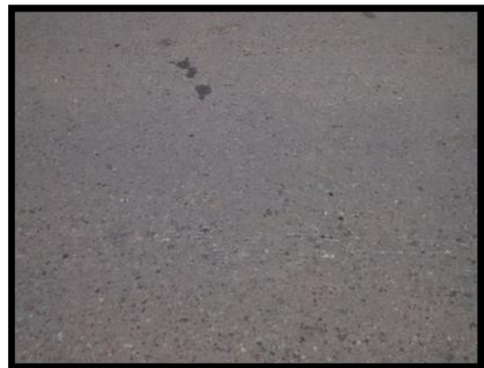
Foto 18: Desprendimiento de Agregados.
