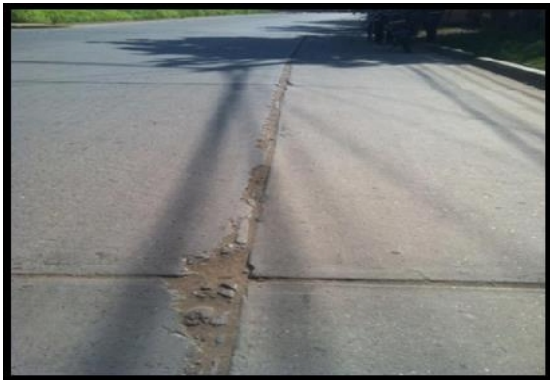
Foto N° 03: Rotura de esquina
