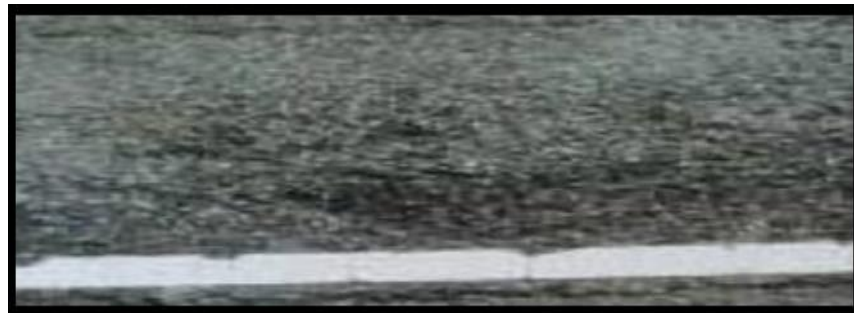
Figura N° 68. Disgregación y desintegración nivel M
