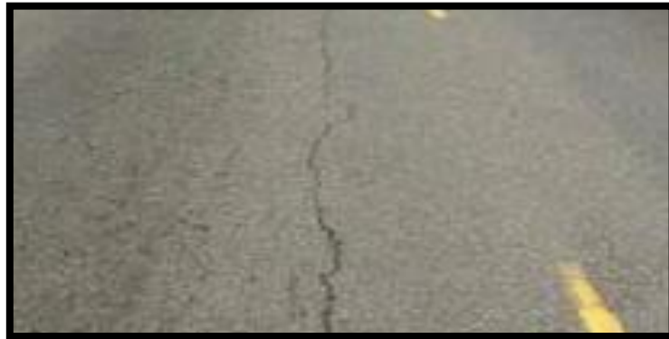
Figura N° 46. Grieta Longitudinal Transversal nivel L
