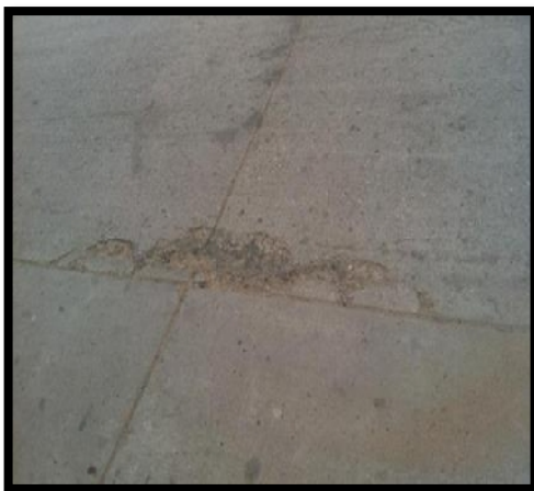
Foto N° 11: Agrietamiento tipo mapa
