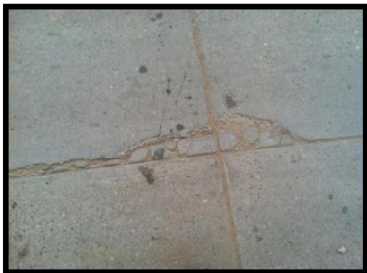
Foto N° 05: Rotura de esquina
