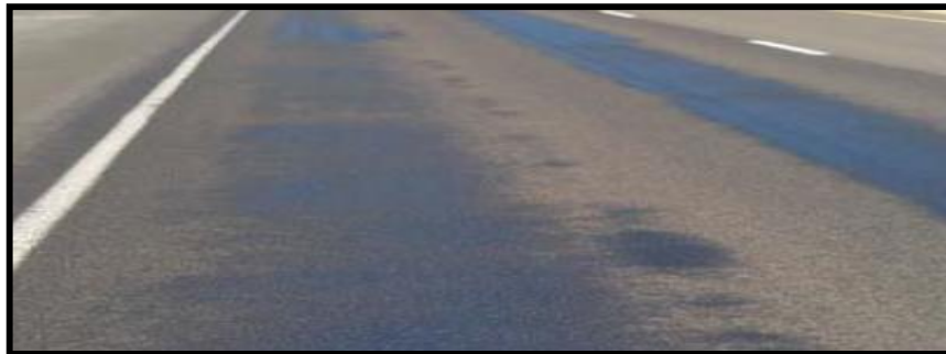
Figura N° 23. Mancha de pavimento nivel M.
