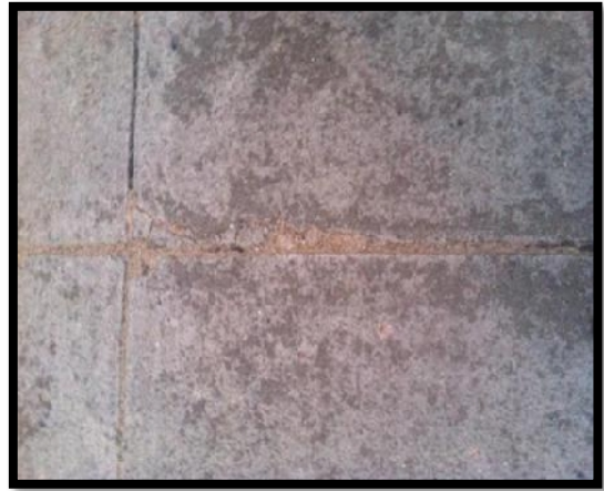
Foto 08: Astillamiento de juntas
