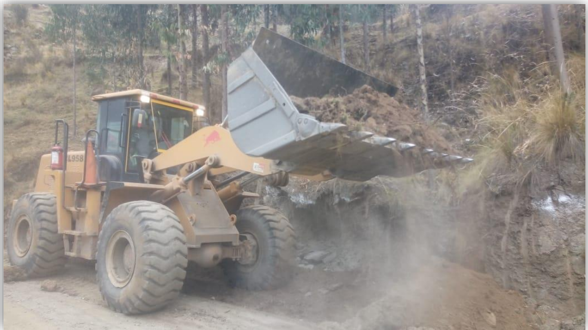
FOTOGRAFIA N°06: ACUMULACIÓN DE MATERIAL EXCEDENTE PARA CARGA.
