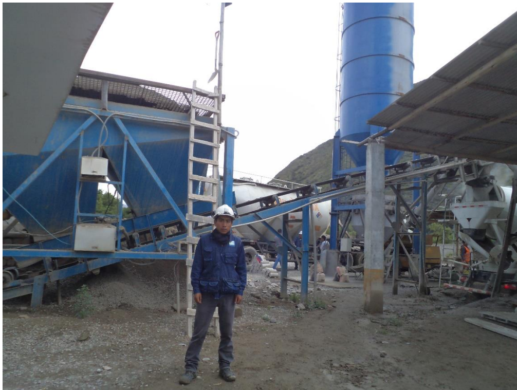
Fotografía N°4: A la izquierda la tolva de agregados y la derecha el silo de cemento.
