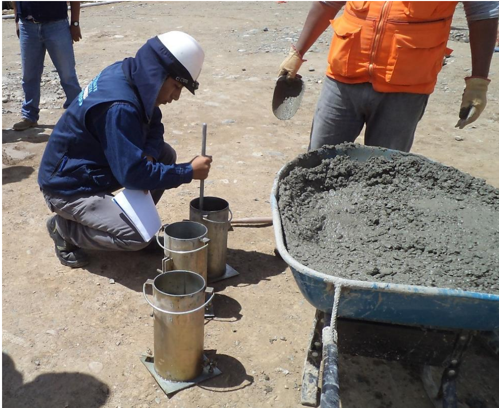
Fotografía N°19: Realizando los especímenes de concreto 6"x12" para realizar el ensayo a compresión.
