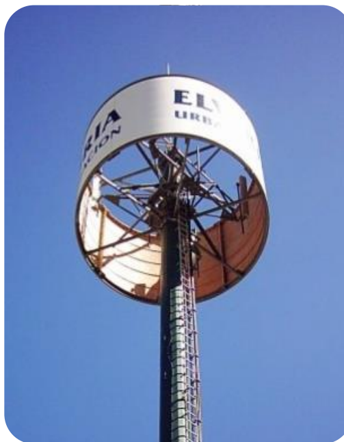
Figura 26. Mimetizado de torre monopolo tipo panel circular
