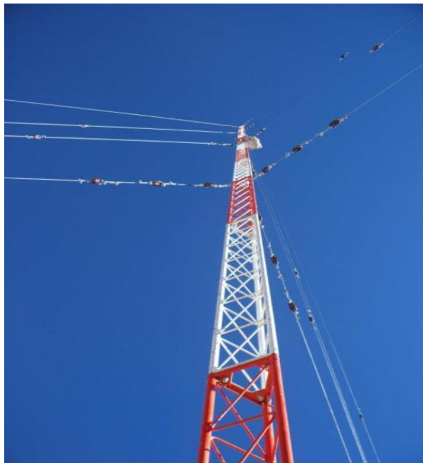
Figura 11. Vista de torre ventada
