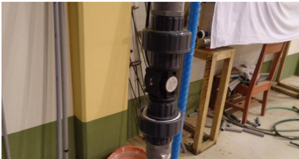
Fotografía 7. Sensor de Flujo instalado al final de la línea de Prueba.
