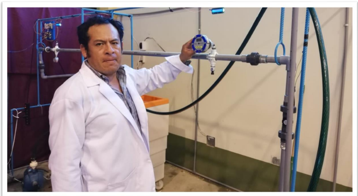
Fotografía A-2. Instalación del sensor de presión RD522.
