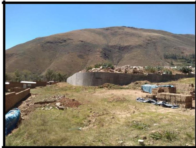
Imagen 14: Muro que resiste el peso de los escombros generados de la construcción del Hospital HERMILIO VALDIZAN
