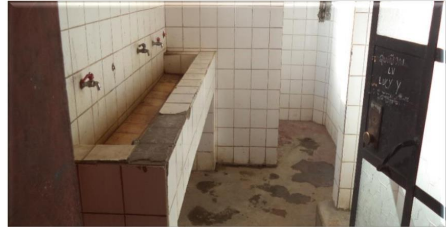
Imagen 16: Lavaderos en mal estado de la Institución Educativa INDUSTRIAL HERMILIO VALDIZAN
