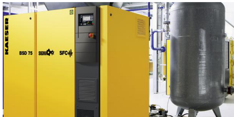
Figura N° 05 COMPRESORA MAS TANQUE PULMÓN
