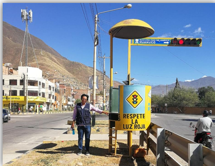
Figura N°26. Identificación de caseta de control. Fuente: Elaboración propia.
