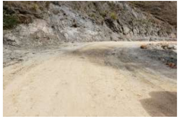
Baden 2 Progresiva: 1+350 km, falta de mantenimiento
