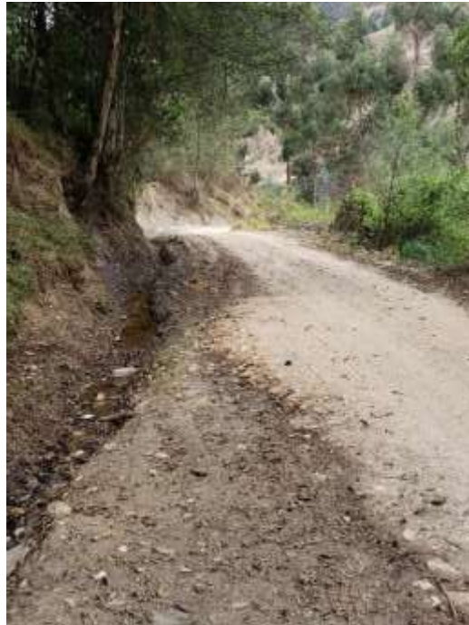
Figura 16. Cunetas obstruidas por hojas de la vegetación que predomina en la zona
