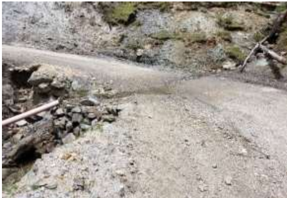
Baden 6 Progresiva 13+741 km, mala condición.
