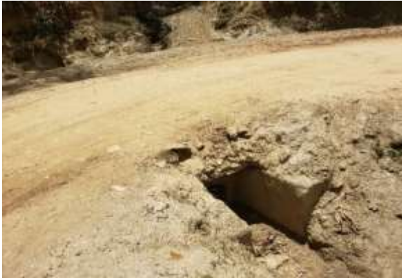
Alcantarilla 13 Progresiva: 10+355 km, falta de mantenimiento.
