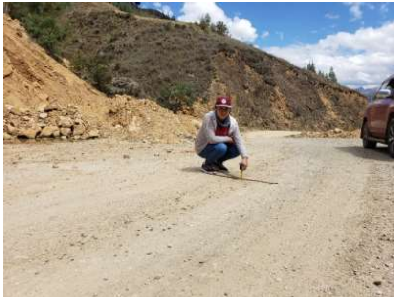
Figura 10. Deformación de nivel 1 en el camino vecinal FUENTE: Fotografía Propia
