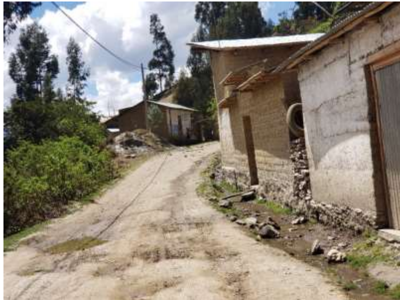
Figura 12. Baches causados por las lluvias y el mal drenaje FUENTE: Fotografía Propia
