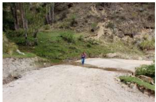
Baden 1 Progresiva: 0+717 km, falta de mantenimiento.
