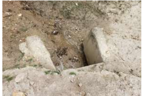
Alcantarilla 14 Progresiva: 10+564 km, falta de mantenimiento.
