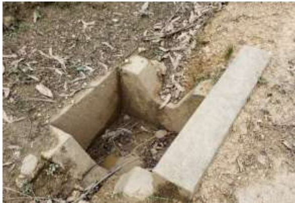
Alcantarilla 26 Progresiva: 15+172 km, falta de mantenimiento.
