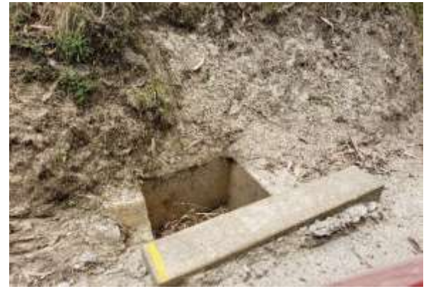
Alcantarilla 24 Progresiva: 14+901 km, falta de mantenimiento.
