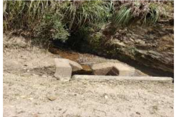
Alcantarilla 23 Progresiva: 14+599 km, falta de mantenimiento.
