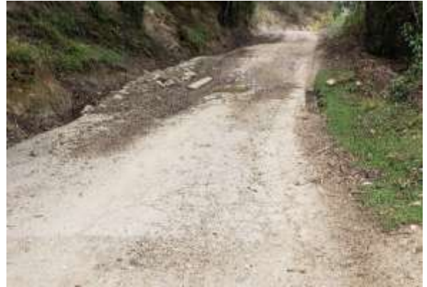
Baden 8 Progresiva 15+219 km, mala condición.
