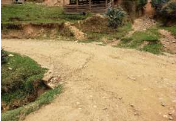
Alcantarilla 19 Progresiva: 12+543 km, falta de mantenimiento
