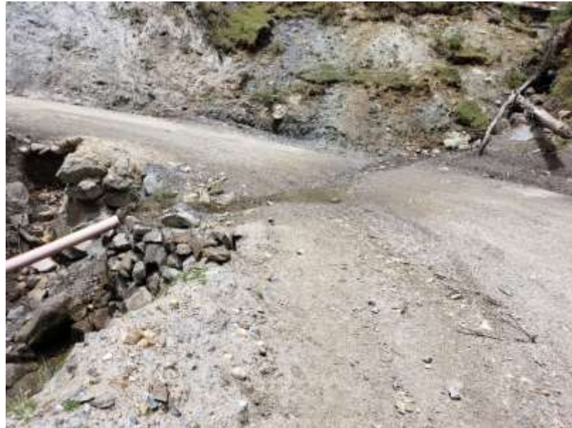
Figura 13. Cruces de agua, falla resultante de un drenaje deficiente FUENTE: Fotografía Propia
