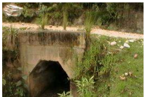
Alcantarilla 25 Progresiva: 15+136 km, falta de mantenimiento.
