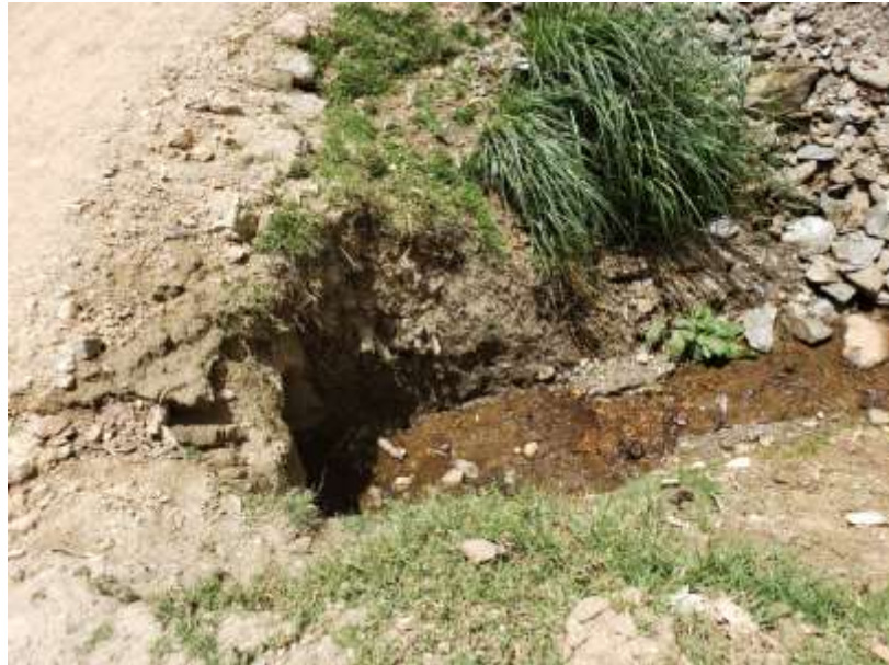
Figura 15. Alcantarilla de concreto en regular condición, falta de mantenimiento
