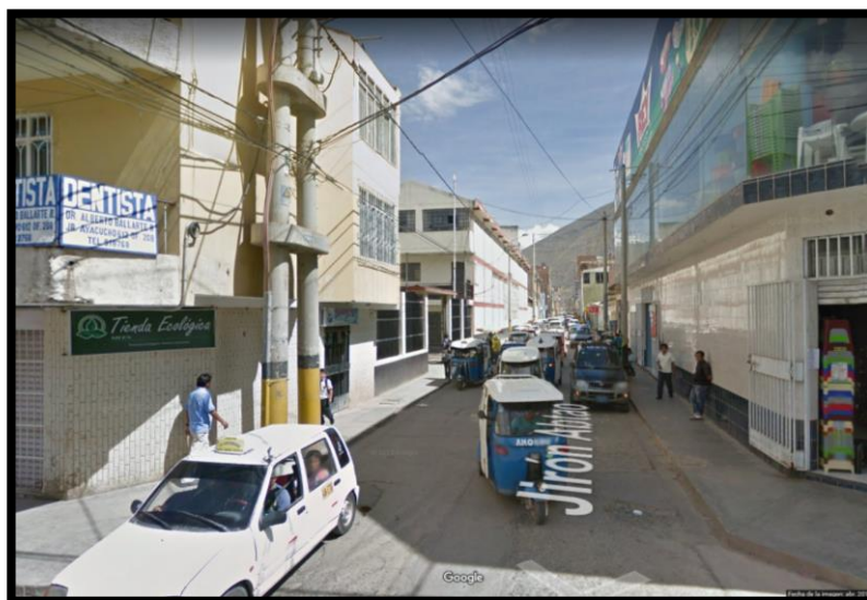
Imagen N° 02: Infraestructura Vial en mal estado Intersección Jr. Abtao y Jr. Ayacucho
