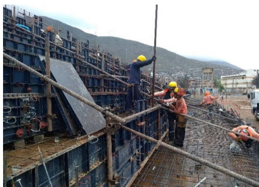
Fotografía N° 29: Control de Alineamiento y plomado en vaciado de pasos y contra pasos.
