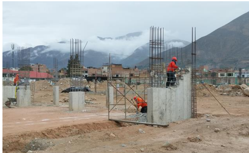
Fig. 14 (incompatibilidad constructiva – RE-TRABAJOS) Fuente: Obra.
