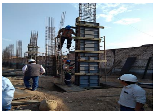
Foto N° 05: Ejecución de la Partida 05.01.03.03.05.02 Encofrado y Desencofrado Caravistas Columnas en el 123 - Sector Occidente
