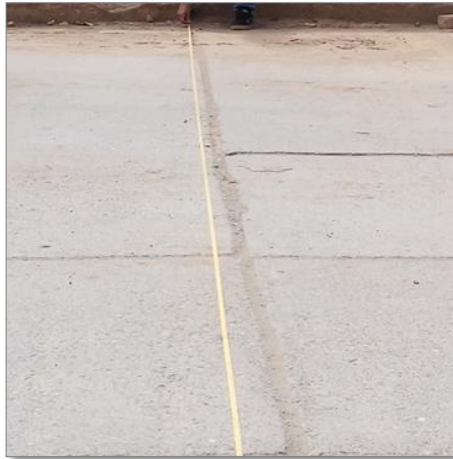
Figura N° 7: Descascaramiento de juntas en losas de pavimento rígido.
