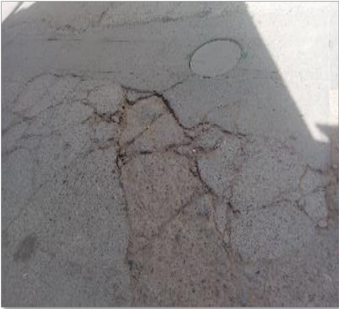
Figura 2: Fisura en bloque.
