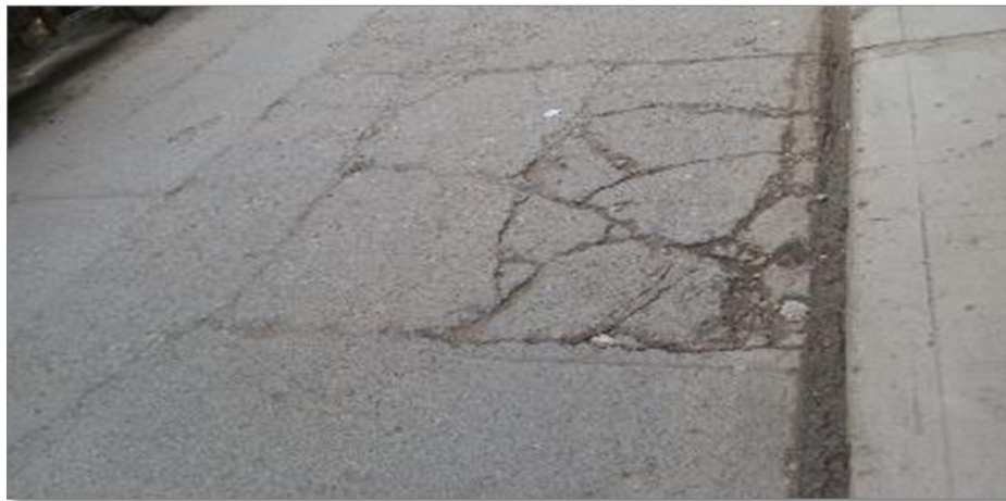
Figura N° 3: Piel de cocodrilo y ahuellamiento en pavimento flexible.
