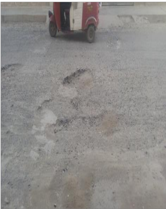
Figura 3: Fisura en bloque.
