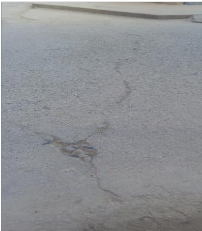
Figura 2: Fisuras transversal y longitudinal.
