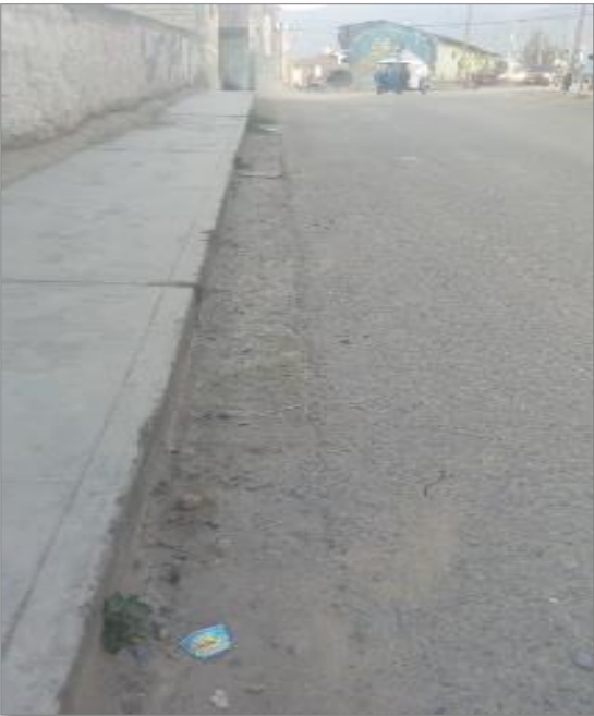
Figura 2: Grieta de borde.
