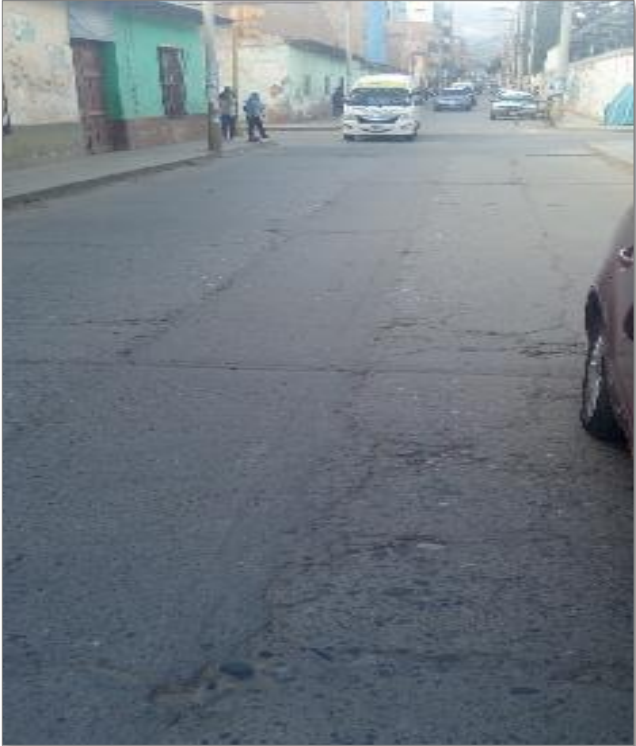
Figura 3: Grieta lineal y parcheo grande.
