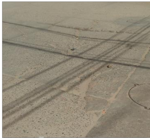
Figura N° 111: Fallas descascaramiento de esquina en pavimento rígido.
