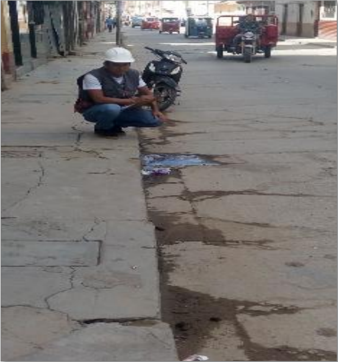
Figura 1: Fisura en bloque.
