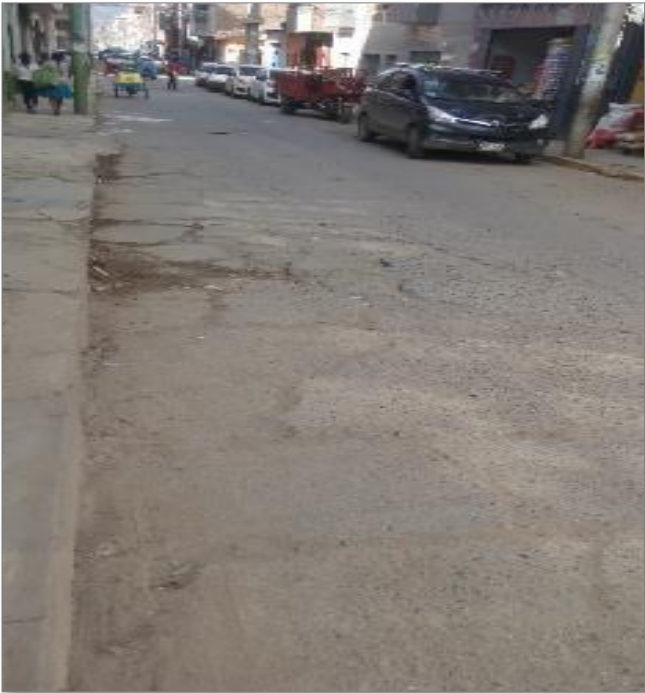
Figura 1: Fisura en bloque.
