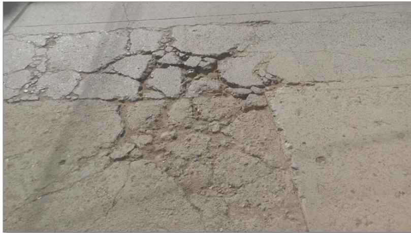
Figura N° 10: Cracking de agrietamiento en pavimentos.
