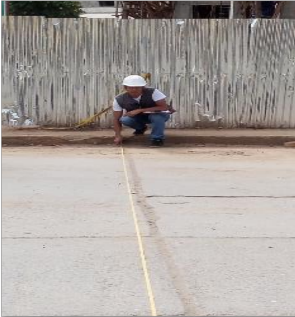
Figura 1: Descascaramiento de junta.
