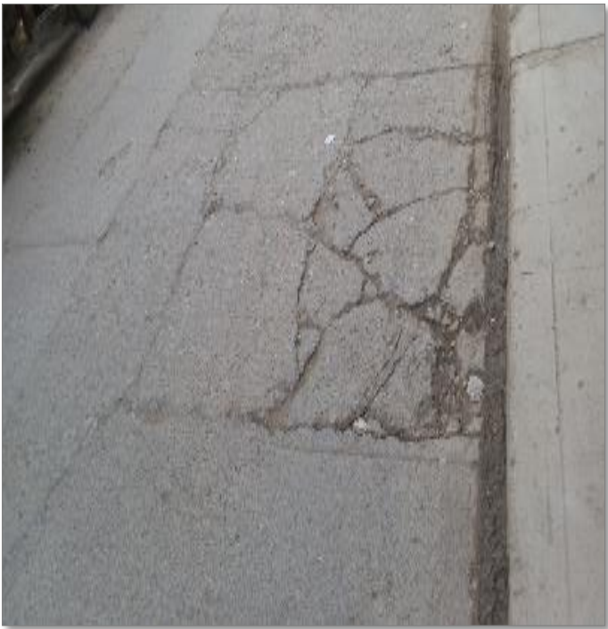
Figura 1: Fisura en bloque y parcheo.
