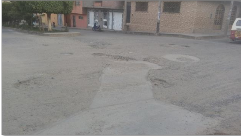
Figura N° 6: Huecos en pavimento flexible.
