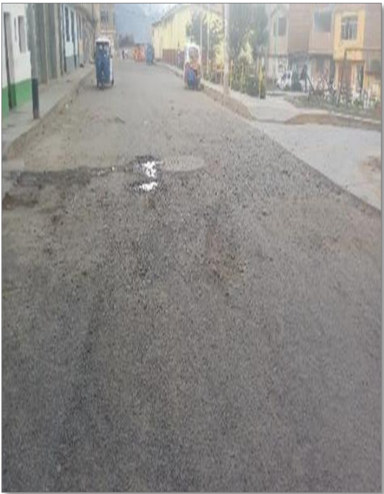
Figura 3: Baches y Desprendimiento de agregados.
