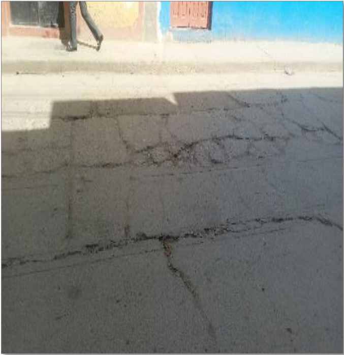
Figura 1: Parche y fisura en bloque.
