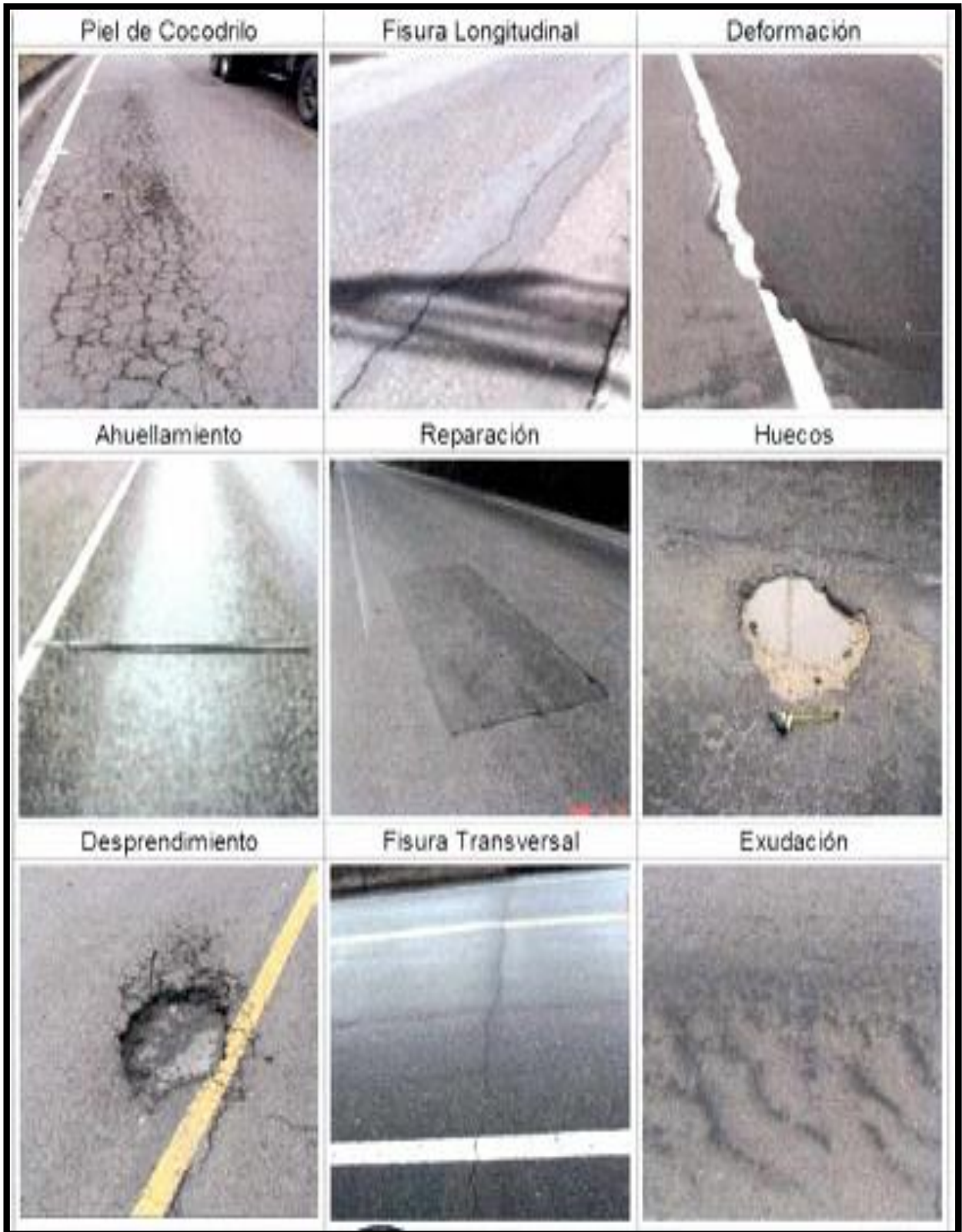
Figura N° 1: Daños en Pavimentos Flexibles
