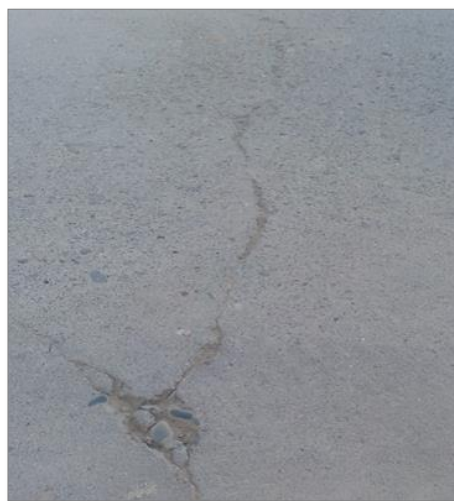
Figura N° 13: Cracking lineal en pavimentos rígidos.
