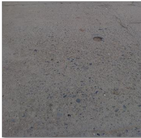
Figura N° 9: Agregados Pulidos en pavimento rígido.
