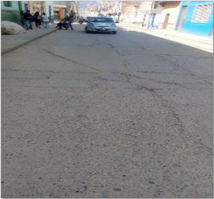
Figura 2: Fisura en bloque.
