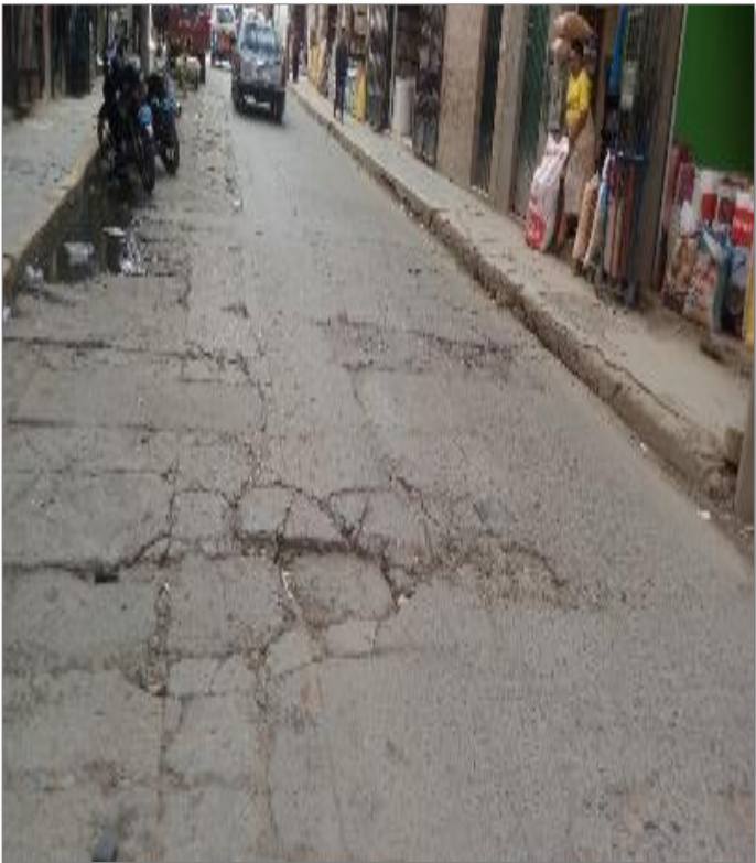
Figura 2: Fisura en bloque.
