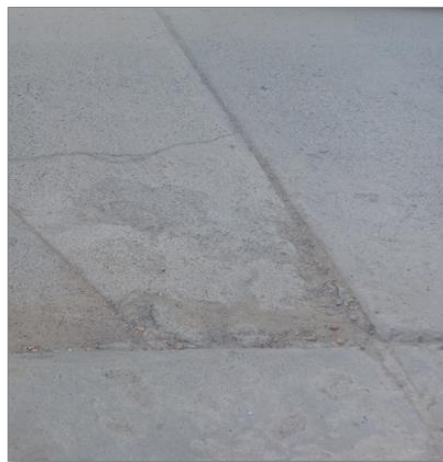
Figura N° 8: Fallas con diferencia en las elevaciones encontradas entre las uniones.
