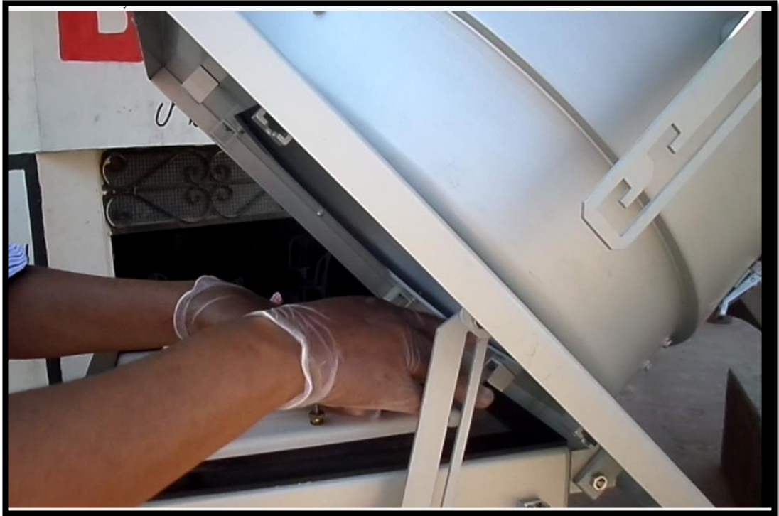
Foto 5. Colocando los filtros en el equipo.
