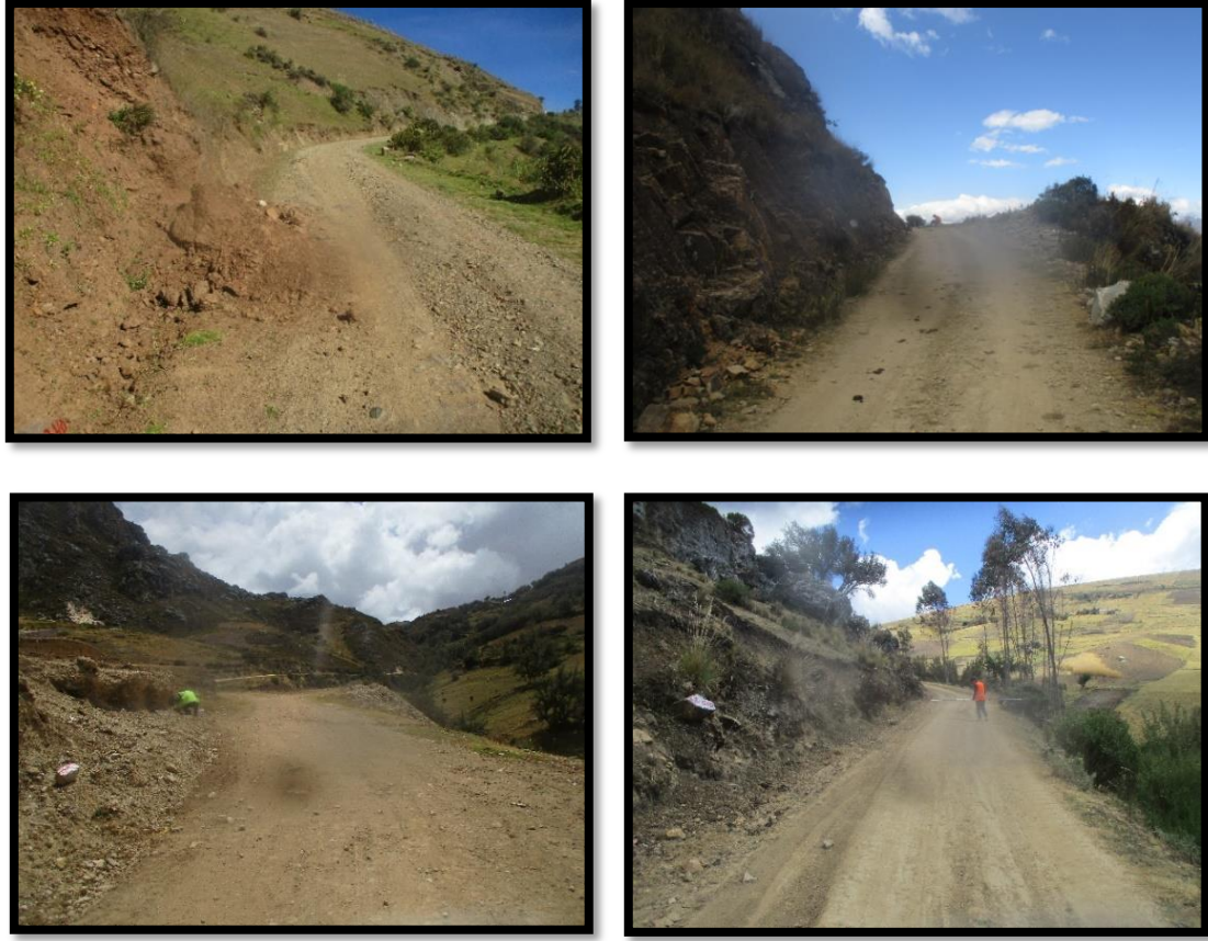
Ilustración N° 4: Deslizamiento de Material a la Vía a Mejorar.
