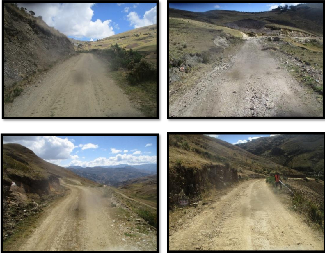
Ilustración N° 5: Superficie de Rodadura en Desgaste y Deterioro.
