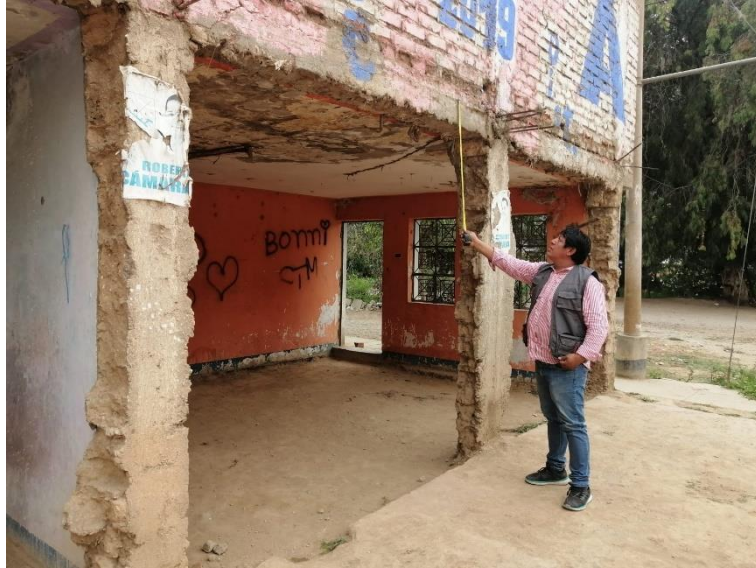
Imagen N° 3: Verificación de las dimensiones de la sección de viga de la vivienda en estudio.
