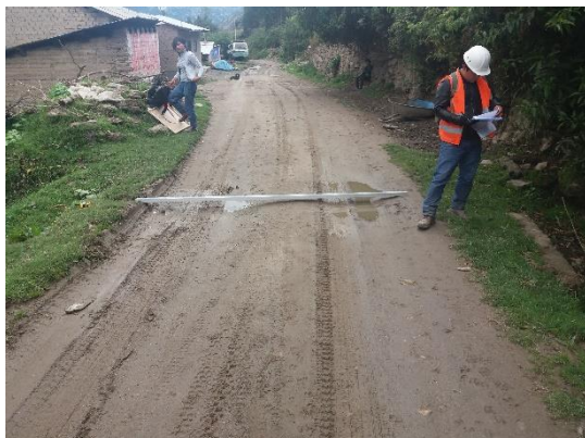
Figura 11. Identificación de deformación.
