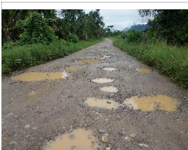
Figura 46. Medición de daño BACHES , G=3 . Progresiva: 62+200.00 km.
