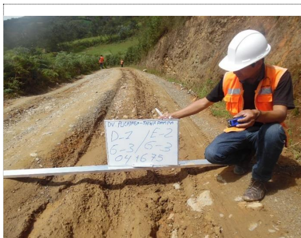
Figura 62. Medición de daño DEFORMACIÓN, G=2. Progresiva: 0+287.54 km.
