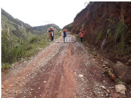
Figura 11. Identificación de erosión.
