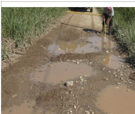
Figura 48. Medición de daño BACHES, G=3. Progresiva: 3+100.00 km.
