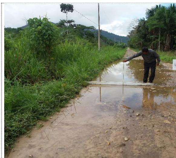
Figura 50. Medición de daño BACHES, G=3. Progresiva: 3+000.00 km.
