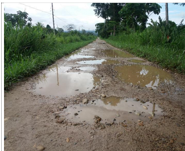
Figura 52. Medición de daño BACHES, G=3. Progresiva: 12+294.38 km.
