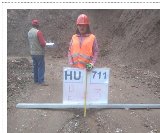
Figura 40. Medición de daño EROSIÓN, G=3. Progresiva: 14+687.33 km.
