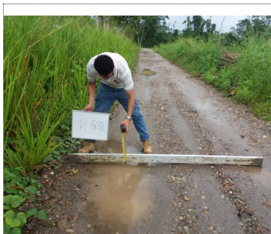
Figura 44. Medición de daño BACHES, G=2. Progresiva: 11+715.53 km.
