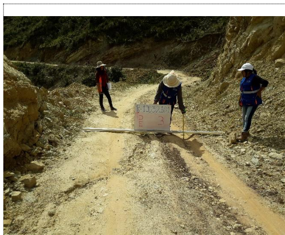
Figura 56. Medición de daño EROSIÓN , G=3. Progresiva: 0+335.13 km.
