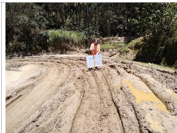
Figura 64. Medición de daño DEFORMACIÓN, G=2. Progresiva: 13+135.47 km.
