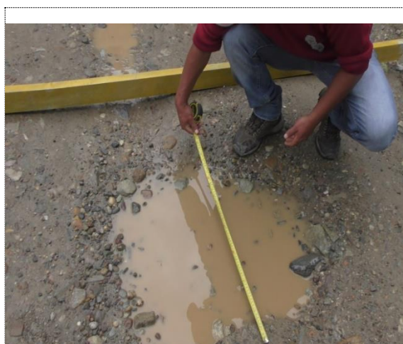
Figura 42. Medición de daño BACHES, G=2. Progresiva: 4+300.00 km.
