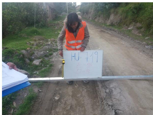
Figura 16. Identificación de deformación.
