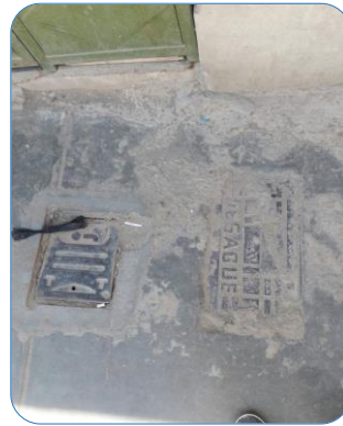
TAPAS DE AGUA Y DESAGUE
