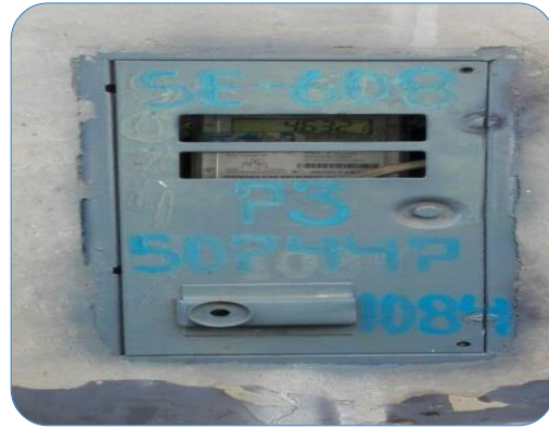
CAJA DE ENERGIA ELECTRICA
