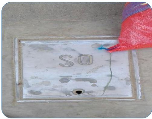
TAPA DE AGUA POTABLE
