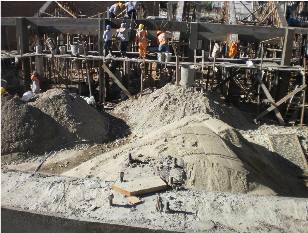
Procedimientos constructivos tradicionales que generan impactos ambientales negativos, como contaminación del aire y sonoros.
