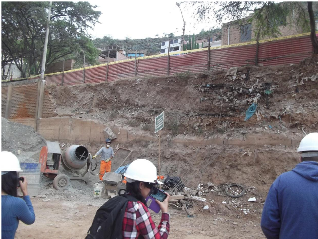
Desnivel en el lado Oeste de la IEI San Pedro, donde se evidencia estratos con contaminación del suelo generado por acumulación de residuos y materia orgánica.
