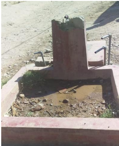
Fotografía N° 3- piletas públicas en en mal estado y sin mantenimiento en sector 01 - Moraspampa
