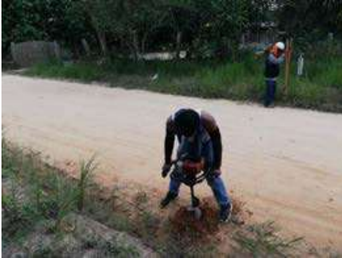
Fotografía 7. – extracción de material en ambos lados de la vía UC-583.
