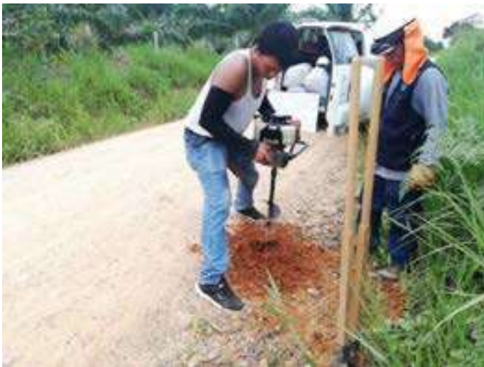
Fotografía 5. – perforación de la calicata en el hito al lado derecho de la vía UC-583, en la parte posterior se puede apreciar el vehículo de transporte del material para los ensayos.
