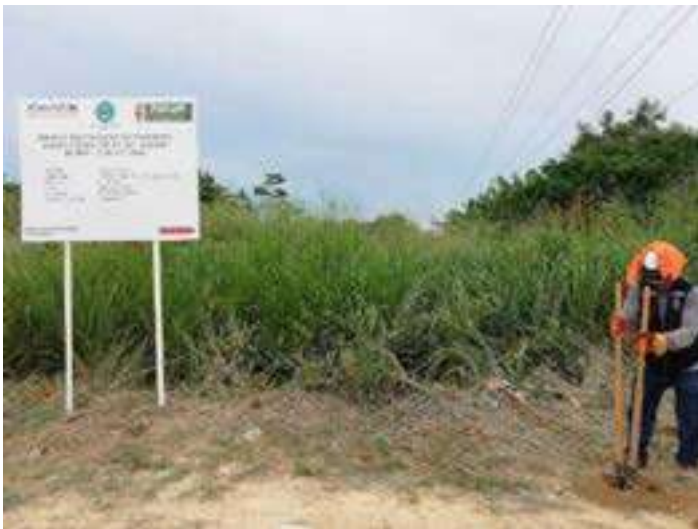
Fotografía 8. – extracción de material en la parte inicial de la vía al lado izquierdo, así también, se puede apreciar un cartel mantenimiento periódico de la Municipalidad Provincial de Coronel Portillo.
