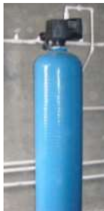
Figura 6 Filtro de carbón activado
