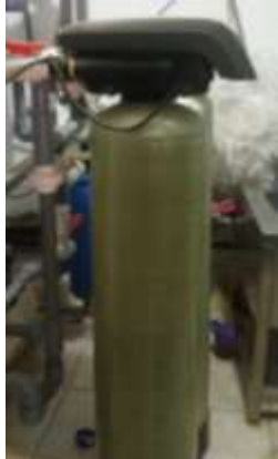
Figura 5 Filtro de arena y grava
